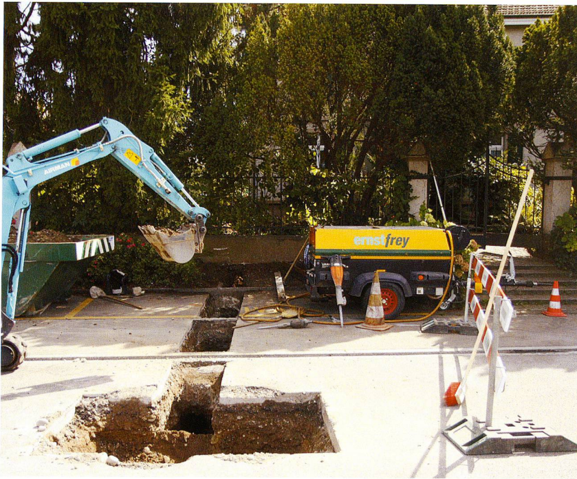
Abb. 69: Kaiseraugst AG, Gasleitung Bahnhofstrasse 20 (Baubegleitung 2011.014). Leitungsgraben, Situation im Strassenbereich während der Bauarbeiten. Blick von Norden.
