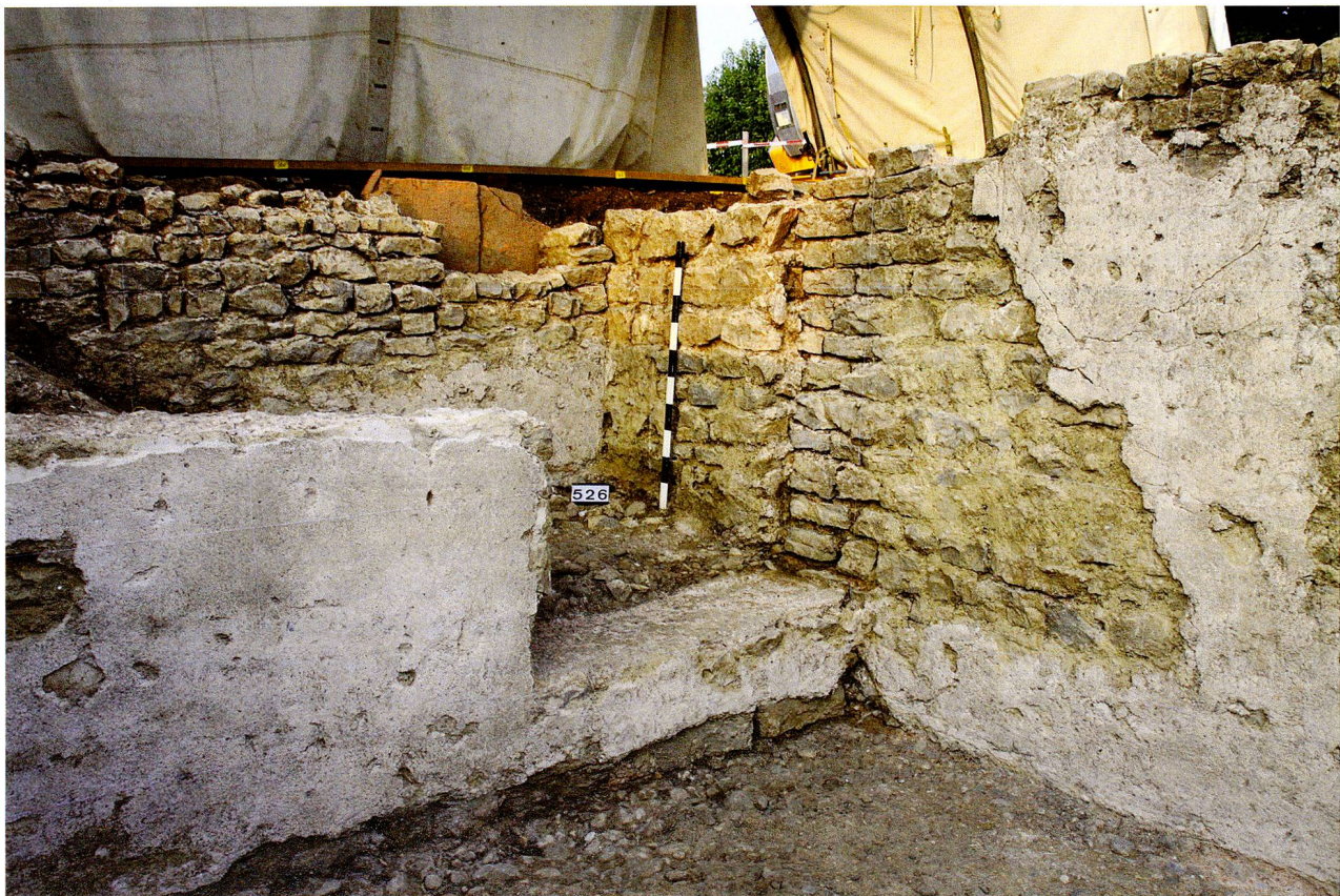
Abb. 15: Kaiseraugst AG, Auf der Wacht (Grabung 2011.001). Eingangssituation in den unterirdischen Raum, Blick von Osten. Die Standorte der Schwelle und des Türrahmens sind gut ersichtlich. Dahinter sieht man die Standnische im Kellerhals.
