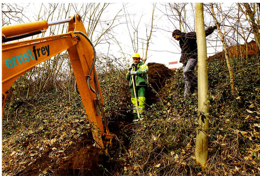
Abb. 52: Kaiseraugst AG, Glasfaserleitung E. Frey AG (Baubegleitung 2011.003). Begleitung während des Aushubs für die Glasfaserleitung im Steilhang zwischen der Landstrasse und dem Violenbach.
