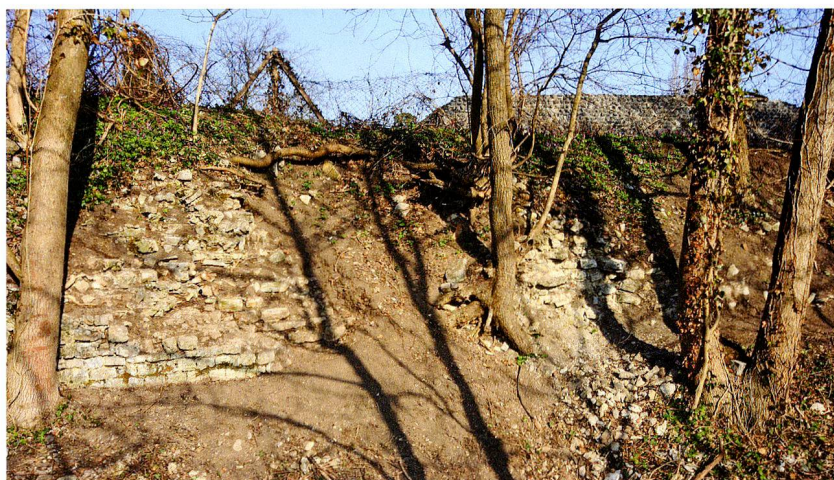
Abb. 21: Augst BL, Schönbühl Umfassungsmauern (Vorgang 2012.054). Die Einwirkung der Tritterosion (Bildmitte, zwischen den Baum-schatten) und des Baumwuchses (links) auf Mauer MR 3 und Mauer MR 4 ist deutlich erkennbar (vgl. Abb. 19; 20). Von Westen.
