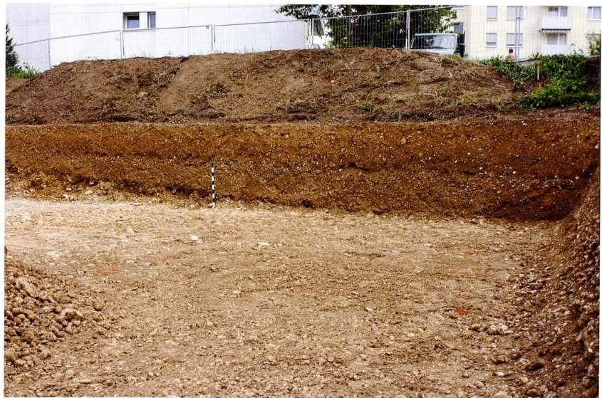
Abb. 26: Pratteln BL, Rheinstrasse (Grabung 2012.061). Südprofil der Baugrube. Die in Abbildung 25 erwähnte Mulde setzt sich gegen Osten fort, keilt aber in diesem Profil aus. Die Muldenverfüllung liegt beim oberen Ende des Fotojalons. Von Norden.
