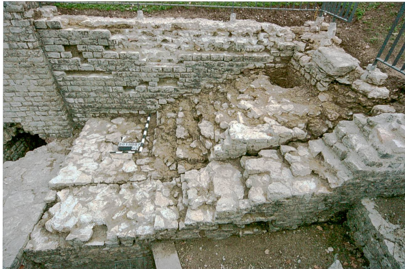
Abb. 23: Augst BL, Stützmauern Basilica (Grabung 2013.057). Der erhaltene Originalteil der Treppe (MR 3) im Treppenhaus nach dem Entfernen der Restaurierungen von 1941. Von Nordwesten.
