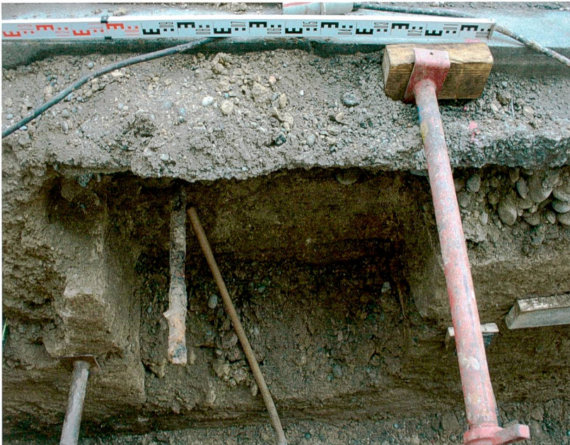
Abb. 21: Augst BL, Wasserleitung Hauptstrasse (Grabung 2014.052). Kellermauern der Vorgängerbauten der heutigen Liegenschaft Hauptstrasse 22 (Abb. 10,4; 18,4) mit Lichtschacht. Von Süden.
