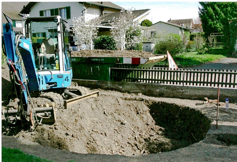
Abb. 43: Augst BL, Thermenstrasse 7 (Grabung 2015.056). Die Aushubarbeiten waren bereits im Gange, als das Grabungsteam über das Vorhaben informiert wurde. Von Nordwesten.
