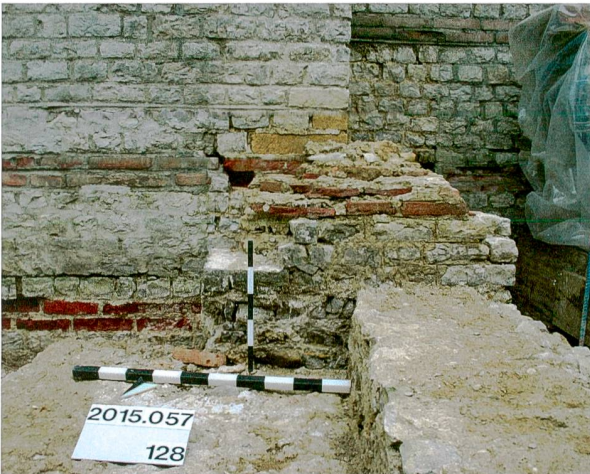
Abb. 56: Augst BL, Basilica-Stützmauern (Grabung 2015.057). Bemerkenswert sind die gute Erhaltung der originalen Mauersubstanz von MR 16 (vgl. Abb. 54 und 55), die antiken Fugenstriche im Mörtel sowie die Ausgestaltung des Ziegeldurchschusses. Von Nordwesten.
