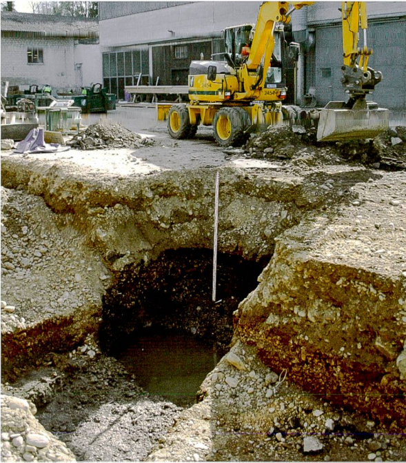
Abb. 34: Augst BL, Werkhof E. Frey AG (Grabung 2015.054). Tief geführter Aushub zur Abklärung der Terrainverhältnisse im westlichen Teil der geplanten Werkhalle. Von Westen.
