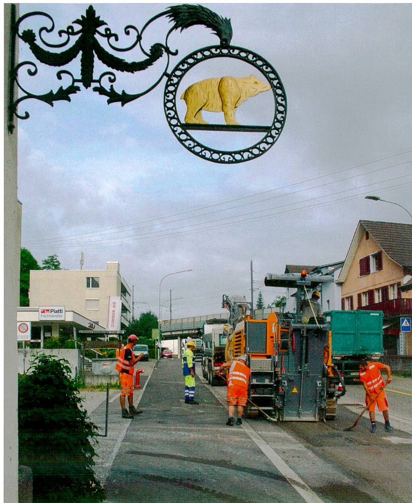
Abb. 82: Augst BL, Hauptstrasse Belagserneuerung (Grabung 2015.061). Abfräsen des alten Belags auf der südlichen Fahrbahn. Von Osten.
