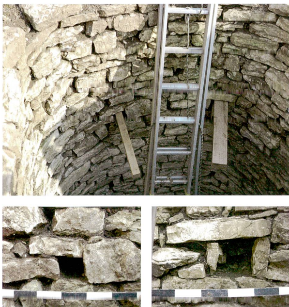
Abb. 7: Kaiseraugst AG, Auf der Wacht (Grabung 2011–2013.001). Schacht MR 6/MR 32 (Zustand im März 2016). Mit modernen Holzbalken markierte Balkennegative in MR 6 und Detailaufnahmen der beiden Balkennegative (vgl. dazu auch Abb. 9).
