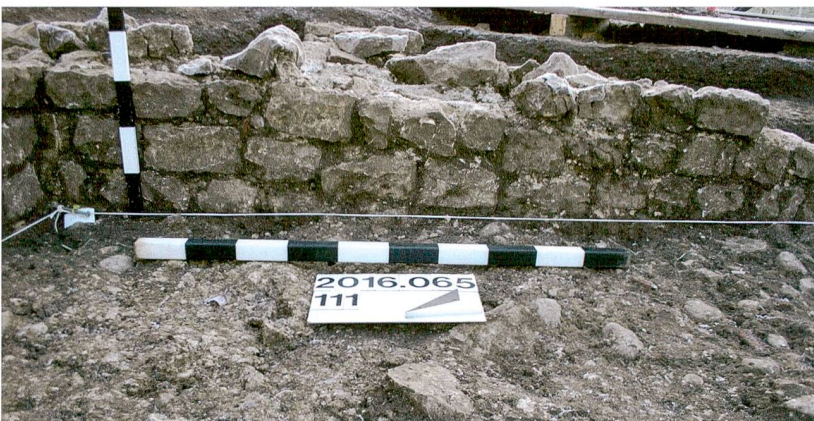
Abb. 73: Augst BL, EFH Sichelstrasse (Grabung 2016.065). Anstoss von Mauer MR 3 (links im Bild) und Mauer MR 9 (rechts im Bild) an Mauer MR 4 (in der Bildmitte etwas heller), die in der Frontansicht verblendet ist. Schnurhöhe 285,25 m ü. M. Blick von Nordwesten.
