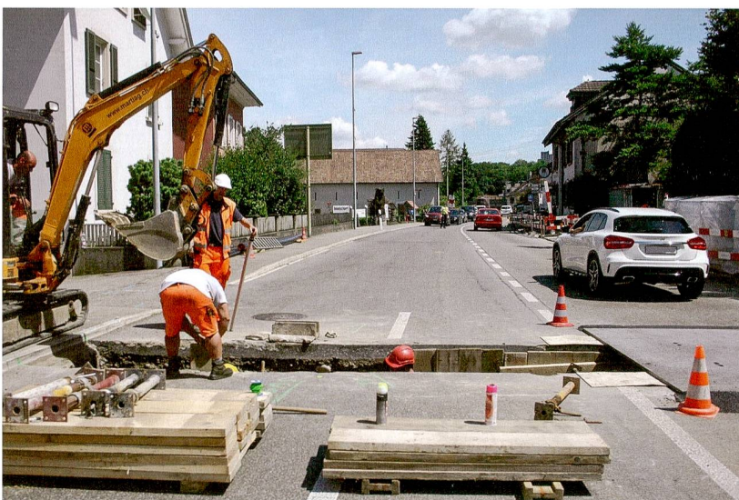
Abb. 8: Augst BL, Rheinstrasse (Grabung 2016.055). Querung der Rheinstrasse für die neue Wasserleitung. Rechts unter der Eisenplatte liegen die Gräber 9–12 und 16. Blick von Westen.
