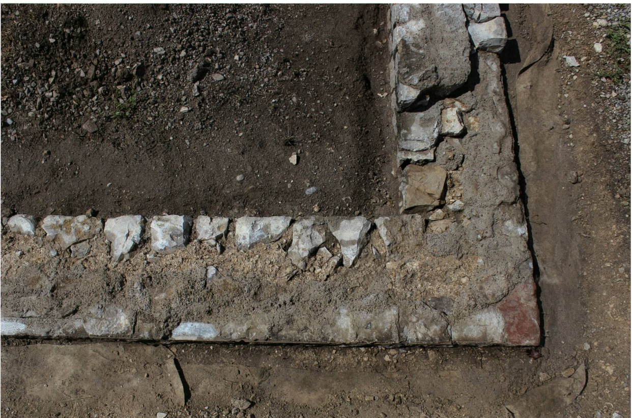
Abb. 35: Augst BL, Vierecktempel Schönbühl II (Intervention 2017.062). Römerzeitliche Mauerlage aus Kalkbruchsteinen und Buntsandsteinen in beigefarbenem Kalkmörtel. Rechts oben Altrestaurierung 1957.061 mit kleineren, regelmässigeren Kalkquadern und dem mit grauem Zementmörtel verfüllten Mauerkerne. Unten am Bildrand markieren Eternitplättchen die Grenze zwischen römischem Originalmauerwerk und den Aufmauerungen von 1957. Blick von Südosten.
