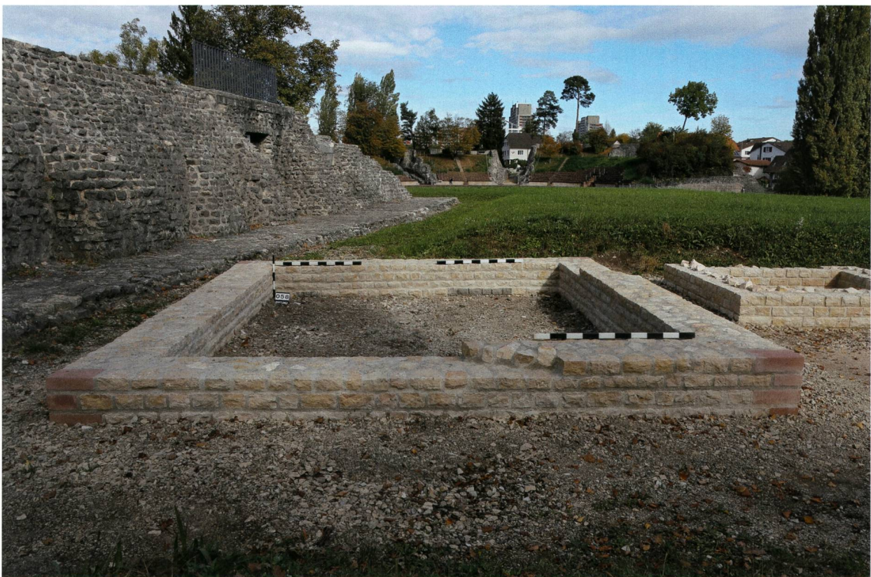
Abb. 38: Augst BL, Vierecktempel Schönbühl II (Intervention 2017.062). Rekonstruiertes Mauergerüst nach Abschluss der Aufmauerung. In der rückwärtigen Mauer sind die grauen Steine der integrierten Altrestaurierung sichtbar. Blick von Südwesten.
