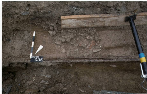
Abb. 55: Kaiseraugst AG, Werkleitungen Bündtenweg (Grabung 2017.014). Blick von Nordwesten auf den Mauerraubgraben der Mauer MR 4.
