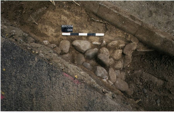
Abb. 52: Kaiseraugst AG, Werkleitungen Bündtenweg (Grabung 2017.014). Blick von Nordwesten auf das Fundament der Mauer MR 1.
