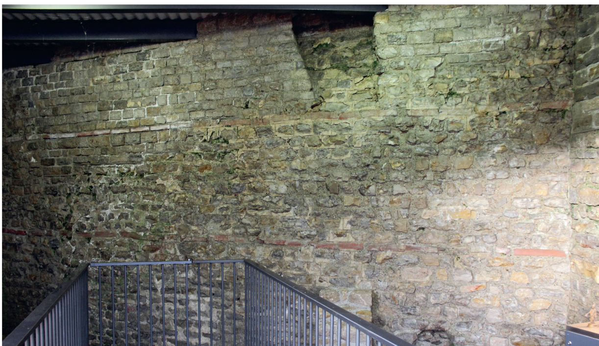
Abb. 16: Augst BL, Taberna (Monumentenrestaurierung 907.2019.01). Noch mehrere Meter hoch erhaltene Rückwand mit starken Veralgungen, Aussinterungen und Salzausblühungen.
