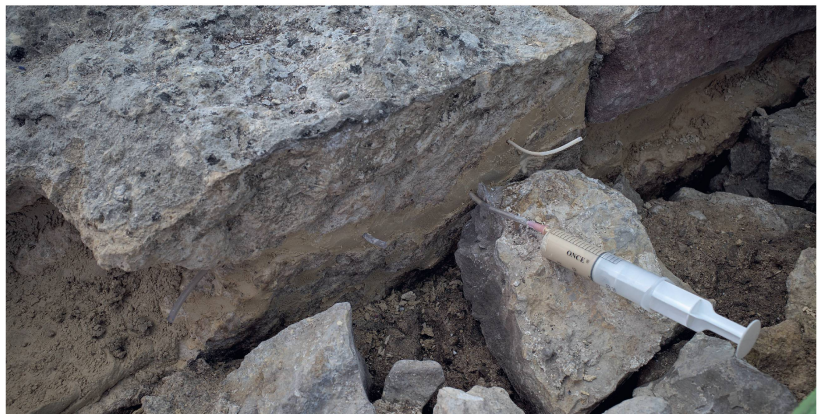
Abb. 3: Augst BL, Schönbühl (Monumentenrestaurierung 903.2019.01). Konservierung eines originalen Stereobatenquaders des Schönbühltempels. Schliessen der Risse durch Injektionen.
