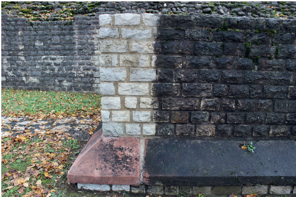
Abb. 26: Augst BL, Theater (Monumentenrestaurierung 924.2019.01). Nordseite beim Eingang zum Nordost-Vomitorium. Reinigungsversuche mit Heissdampf: Gereinigte Eckzone des Stützpfilers mit angrenzender dunkler, ungereinigter Fläche.
