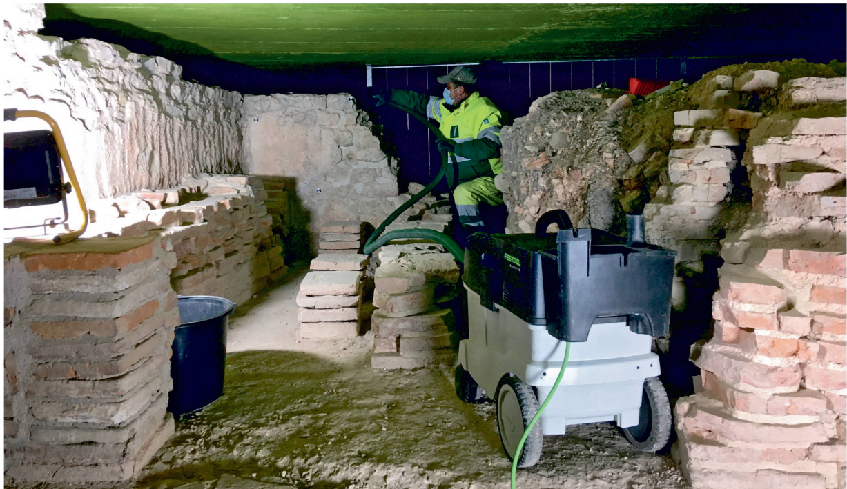
Abb. 23: Kaiseraugst AG, Rheinthermen (Monumentenrestaurierung 916.2020.01). Umfassende Reinigungsarbeiten. Absaugen der Sediment- und Zementstaubschichten auf den Mauern aus Kalkstein und auf den Böden.
