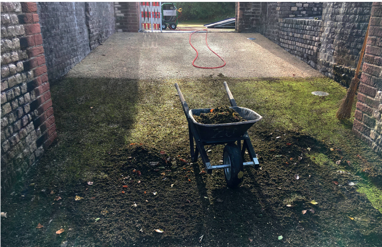
Abb. 42: Augst BL, Theater (Monumentenrestaurierung 924.2020.02). Umfassende Reinigungsarbeiten in den vomitoria und den aditus. Halb fertiggestellte Reinigung im südlichen aditus maximus. Die Moosschicht auf dem Sickerbodenbelag war hier so dick, dass sie vorgängig zur Reinigung mit dem Heissdampfgerät grob von Hand entfernt werden musste. Auch hier ist das Resultat der mit vergleichsweise geringem Aufwand verbundenen Unterhaltsmassnahme eindeutig (vgl. obere Bildhälfte).
