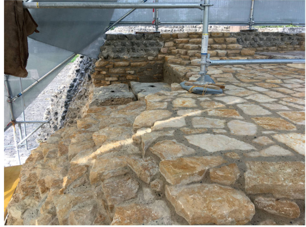
Abb. 9: Augst BL, Schönbühl (Monumentenrestaurierung 903.2020.02). Restaurierung der Stereobatenquader und der SE-Ecke des Tempelpodiums. Südliches in situ erhaltenes Quaderfundament nach Abschluss der Konservierungsarbeiten. Die Oberfläche des noch erhaltenen Kalksteinpodiums wurde mit einer neuen Verschleisschicht abgedeckt, deren Neigung das Oberflächenwasser effizienter von den Stereobaten ableiten soll. Angesichts der knappen Platzverhältnisse zum Aufführen der schützenden Übermauerungen musste die Oberfläche beim südlichen Quaderfundament als Negativform eines heute verschwundenen Quaders ausgebildet werden und dient gleichzeitig als Lesehilfe.
