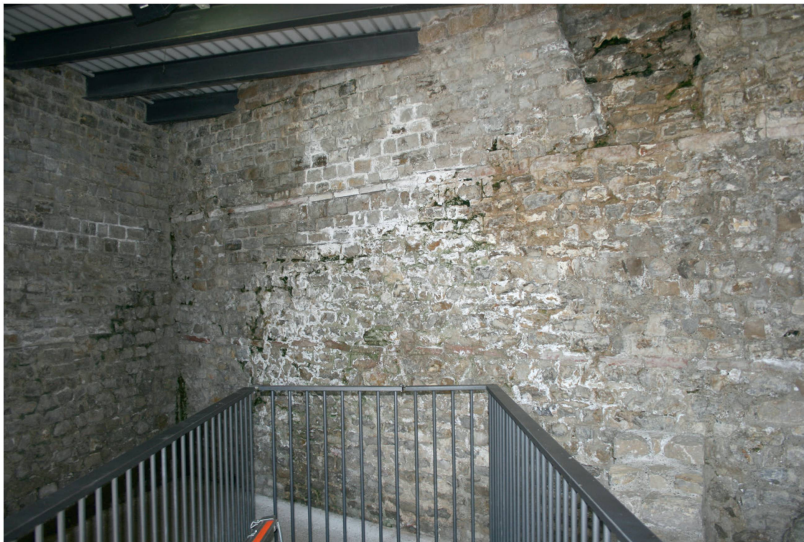
Abb. 20: Augst BL, Taberna (Monumentenrestaurierung 907.2020.01). Reinigung von Algen und starken Salzausblühungen. An der hangseitigen Tabernenrückwand kam es im erneut sehr trockenen Sommer 2020 zu grossflächigen Chloridausblühungen und starker Algenbildung.
