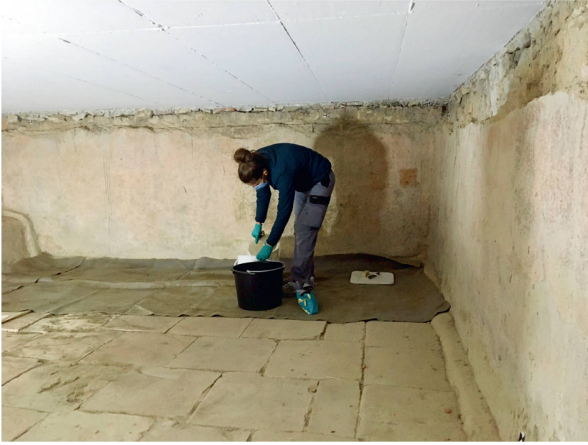
Abb. 24: Kaiseraugst AG, Rheinthermen (Monumentenrestaurierung 916.2020.01). Umfassende Reinigungsarbeiten. Reinigungstests im arg verschmutzten Becken des Frigidariums. An den Wänden und auf dem Boden hat sich Zementstaub festgesetzt, der zu einem alles bedeckenden Grauschleier führt. Der Ziegelmörtelputz (opus signinum) ist mit Zementschlieren verschmutzt, die noch aus der Bauzeit (1975) der überdeckenden Betonplattform stammen.
