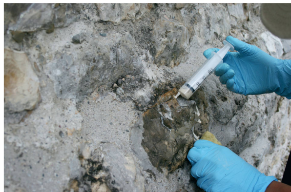
Abb. 31: Kaiseraugst AG, Gewerbehaus Schmidmatt (Monumentenrestaurierung 917.2020.01). Konservierung von Mauerzügen ausserhalb des Schutzbaus. Neukonservierung der originalen Mauerzüge: Nach Reinigung mit Schwamm und Bürste wurden die losen Teile der Handquader wieder angeklebt und die Risse mit einem sehr flüssigen Kalkmörtel gefüllt. Erst im Anschluss an diese Konsolidierung des Steinmaterials konnte der umliegende Portlandzement, sofern er nicht zu tief in die Fugen gepresst worden war, entfernt und durch einen weicheren und diffusionsfähigeren Kalkmörtel ersetzt werden.
