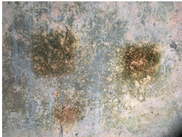
Abb. 27: Kaiseraugst AG, Rheinthermen (Monumentenrestaurierung 916.2020.01). Umfassende Reinigungsarbeiten. Testflächen zur Entfernung der Algen und der stark anhaftenden Schmutzschicht an der Oberfläche der Beckenwände; gut erkennbar sind die Zementschlieren aus der Bauzeit der Betondecke.
