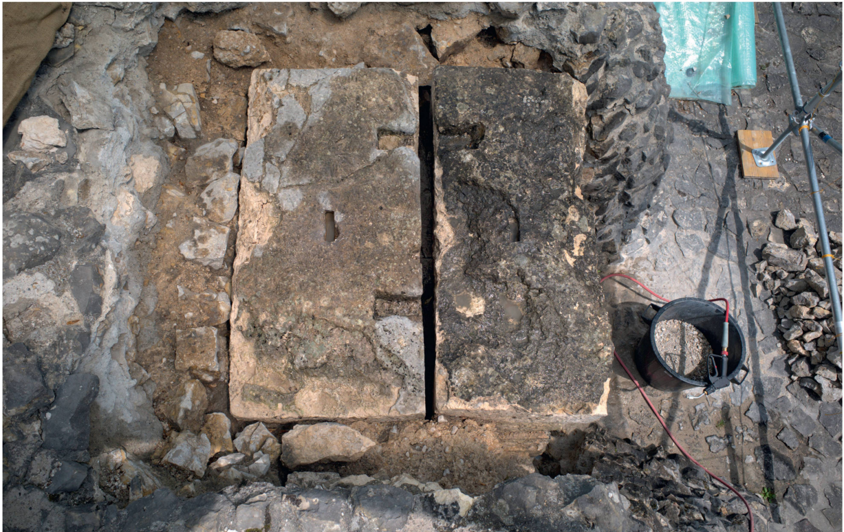
Abb. 5: Augst BL, Schönbühl (Monumentenrestaurierung 903.2020.02). Restaurierung der Stereobatenquader und der SE-Ecke des Tempelpodiums (Aufsicht). Südliches in situ erhaltenes Quaderfundament, Zustand vor Beginn der Arbeiten: Durch Einfluss von Wasser und Frost hatte der fragile Kalkstein bereits begonnen, an verschiedenen Orten abzubrockeln. Zusätzliche mechanische Belastungen durch Begehung verschärften das Problem.
