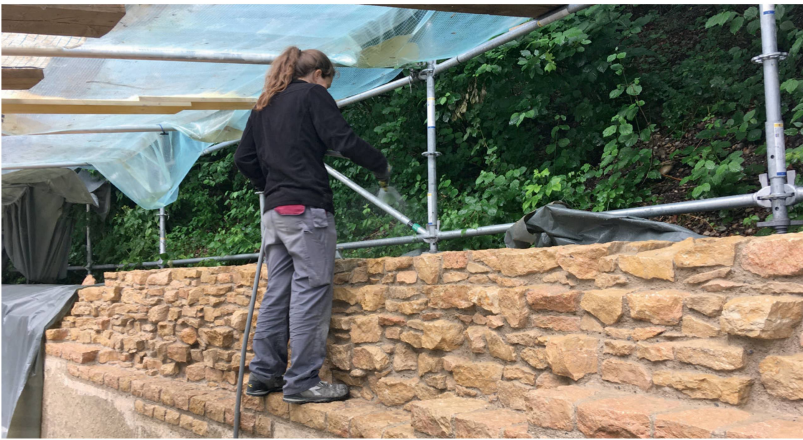
Abb. 18: Augst BL, Amphitheater (Monumentenrestaurierung 905.2020.01). Podiumsmauer, Ersatz von Vormauerungen und Abdichtung, Südwest-Abschnitt. Der neu aufgebaute obere Mauerbereich nach Abschluss der Arbeiten. Die Mauerkrone ist nun besser gegen eindringendes Sickerwasser geschützt und dank der Gestaltung als Steilabbruch wird das Niederschlagswasser effizienter an den Mauerfuß abgeleitet.
