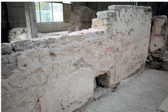
Abb. 36: Kaiseraugst AG, Gewerbehaus Schmidmatt (Monumentenrestaurierung 917.2020.02). Konservierung von Wandmalerei in situ (Couloir Raum 5). Die Westwand (MR 21) von Raum 5 vor Beginn der Konservierungsarbeiten. Trotz der zahlreichen Risse war der Interventionsaufwand erheblich geringer als erwartet, da bei den früheren Konservierungsarbeiten in den 1990er-Jahren deutlich weniger Acrylmörtel zum Einsatz gekommen war.
