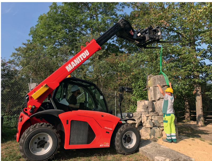
Abb. 11: Augst BL, Schönbühl (Monumentenrestaurierung 903.2020.03). Abbau der Architekturprobe aus dem 19. Jahrhundert. Der Einsatz des Teleskopladers und die Handhabung der fragilen Architekturstücke aus Kalkstein verlangen einiges an Fingerspitzengefühl. Dank dem umsichtigen Einsatz von Steinbildhauer Gian-Titus Heinzelmann und Maurer Mladen Puklin ging der Abbau ohne Unfälle oder Schäden an den wertvollen Bauteilen über die Bühne.
