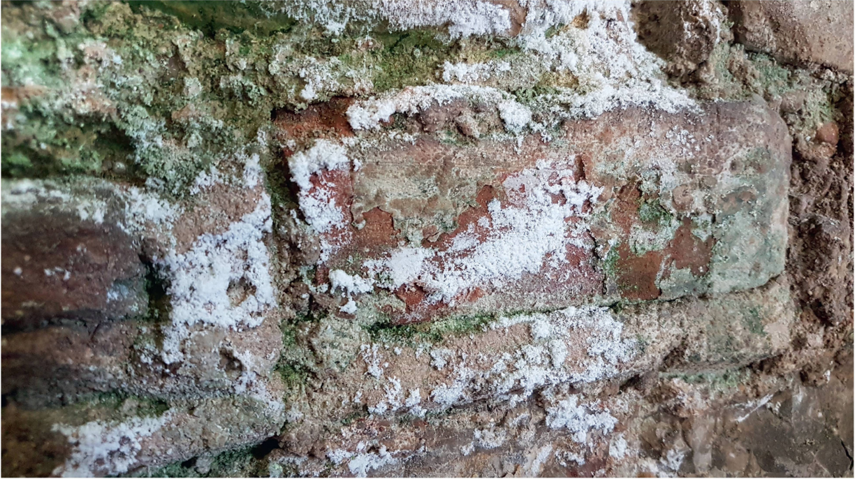
Abb. 21: Augst BL, Taberna (Monumentenrestaurierung 907.2020.01). Reinigung von Algen und starken Salzausblühungen. Die ausblühenden Salze führen zu massiven Abrasionserscheinungen an Mörtel und Steinoberflächen und mittel- bis langfristig zu einer kompletten Zerstörung des noch grossflächig erhaltenen antiken Steinmaterials und Bindemittels.
