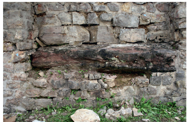
Abb. 29: Kaiseraugst AG, Gewerbehaus Schmidmatt (Monumentenrestaurierung 917.2020.01). Konservierung von Mauerzügen ausserhalb des Schutzbaus. Weit fortgeschrittene Zerfallerscheinungen (Abschieferungen und Absandungen) an der Sandsteinschwelle einer sekundär vermauerten Tür (MR 4) in der Westmauer (MR 3) von Raum 1 (Ansicht von Osten). Unterhalb der Schwelle ist das Mauerwerk durch Wasser- und Frosteinflüsse stark ausgebrochen.
