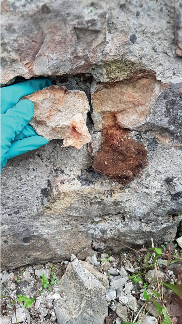
Abb. 30: Kaiseraugst AG, Gewerbehaus Schmidmatt (Monumentenrestaurierung 917.2020.01). Konservierung von Mauerzügen ausserhalb des Schutzbaus. Typisches Schadensbild: Als Folge der früheren Restaurierungen, bei denen die Fugen mit hartem Portlandzement ausgestrichen wurden, sind die Handquader aus Kalkstein zerrissen und zersplittert; Wurzelwerk der Pioniervegetation hat sich in diesen Rissen angesiedelt und akkumuliert Feuchtigkeit in den Quadern, die im Winter zu Frostsprengungen führt.
