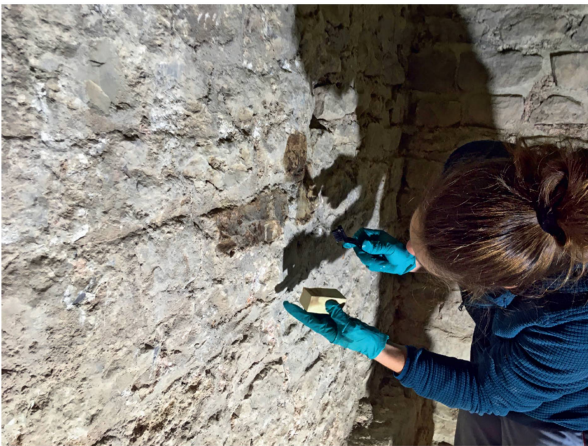
Abb. 26: Kaiseraugst AG, Rheinthermen (Monumentenrestaurierung 916.2020.01). Umfassende Reinigungsarbeiten. Reinigungstest mit Trockenschwamm und wenig Wasser am Kalksteinmauerwerk des Tepidariums.
