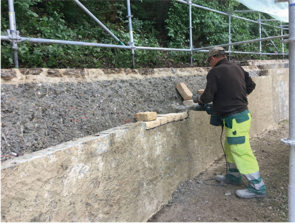
Abb. 16: Augst BL, Amphitheater (Monumentenrestaurierung 905.2020.01). Podiumsmauer, Ersatz von Vormauerungen und Abdichtung, Südwest-Abschnitt. Beginn des Aufbaus der neuen Mauerschale mit Jurakalk aus dem Laufental.
