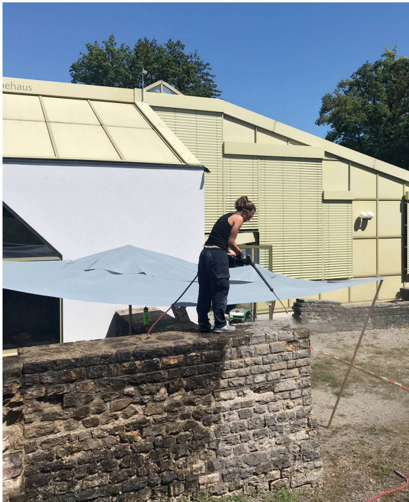
Abb. 28: Kaiseraugst AG, Gewerbehaus Schmidmatt (Monumentenrestaurierung 917.2020.01). Konservierung von Mauerzügen ausserhalb des Schutzbaus. Restauratorin Chiara Marcon, die unser Team seit Juni 2020 verstärkt, bei der Reinigung des Mauerwerks mit sanftem Druck und Heissdampf.
