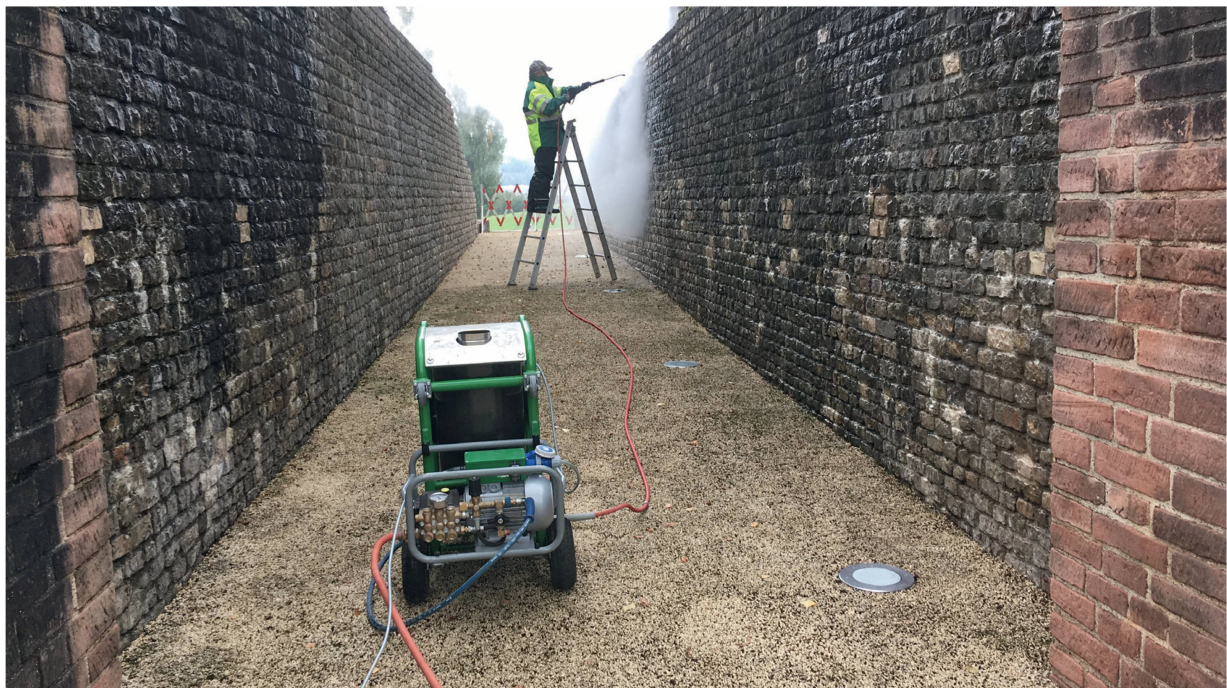
Abb. 40: Augst BL, Theater (Monumentenrestaurierung 924.2020.02). Umfassende Reinigungsarbeiten in den vomitoria und den aditus. Das Nordost-Vomitorium zu Beginn der Reinigungsarbeiten: Boden und Wände sind stark verschmutzt und vermoost und weisen eine schwärzliche Patina auf. Die Sickerfähigkeit des Bodenbelags ist durch die verstopften Poren erheblich beeinträchtigt.
