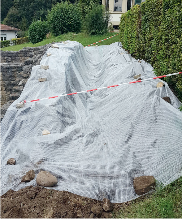
Abb. 29: Augst BL, Taberna (Monumentenrestaurierung 907.2021.01). Der Wasserfluss direkt hinter der Mauer muss zukünftig minimiert werden. Erste Tests haben gezeigt, dass eine grossflächige Abdichtung rund um den Baubefund herum die nötige Effizienz bringt, sodass massiv weniger Wasser in die antike Mauer einsickert. Die Arbeiten werden 2022 fortgesetzt; in dem Zusammenhang ist das Einlegen einer Dichtungsfolie hinter der Mauer vorgesehen.
