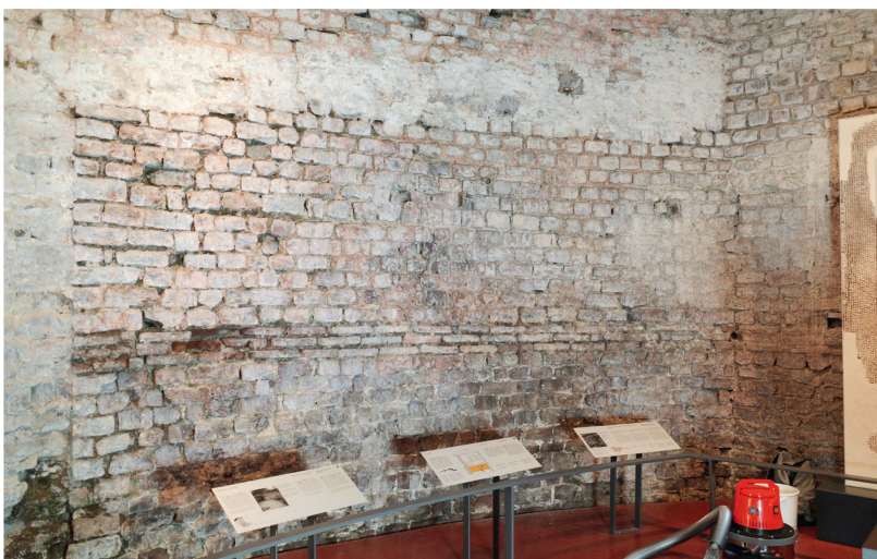
Abb. 20: Augst BL, Curia (Monumentenrestaurierung 906.2021.03). Curia, Reinigung des Innenraums und Entfernen von Actinobakterien ( Rubrobacter ). Die Maueroberflächen der Curia-Innenwände waren grossflächig von einem rötlichen Belag überzogen, der durch den Stein schädigende Rubrobacter -Bakterien entstanden ist. Durch Reinigung mit Heissdampf konnte die Bakterien schicht schonend entfernt werden. Zustand vor der Reinigung.
