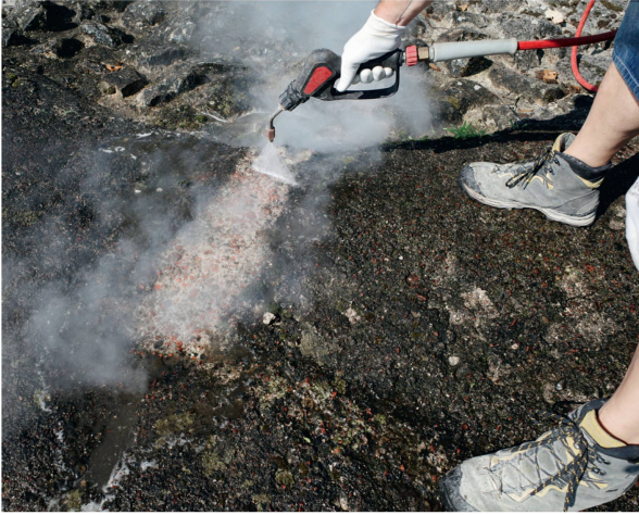
Abb. 32: Kaiseragust AG, Castrum Rauracense (Monumentenrestaurierung 915.2021.01). Auch bei den noch originalen Terrazzoböden im Inneren der Türme erfolgten Reinigungstests mit Heissdampf.
