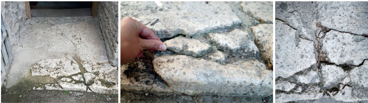
Abb. 16: Augst BL, Curia (Monumentenrestaurierung 906.2021.02). Neukonservierung der Kalksteinschwelle am Eingang zum Curiakeller. Als Folge von Wasser, Frost und intensiver Begehung war die originale Schwelle der ins Untergeschoss der Curia führenden Türe in sehr schlechtem Zustand. Im Stein haben sich viele Risse gebildet und etliche Teile des Steinblocks sind abgeplatzt.
