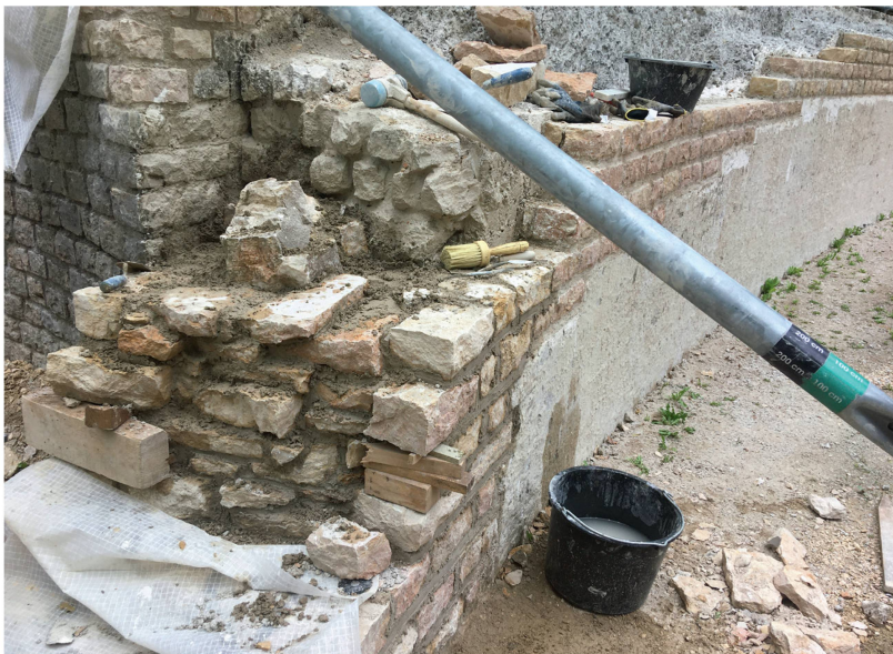
Abb. 8: Augst BL, Amphitheater (Monumentenrestaurierung 905.2021.01). Neu aufgemauert Kernabschluss am Westende. Der Charakter des originalen antiken Mauerkerne soll so gut wie möglich nachempfunden werden.
