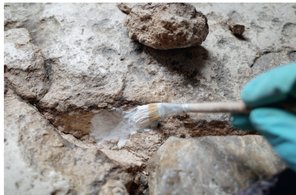
Abb. 18: Augst BL, Curia (Monumentenrestaurierung 906.2021.02). Nach sorgfältigem Entfernen der alten Zementrestaurierungen konnten die losen Teile der originalen Schwelle mit Nanokalk wieder angeklebt und die Risse geschlossen werden.
