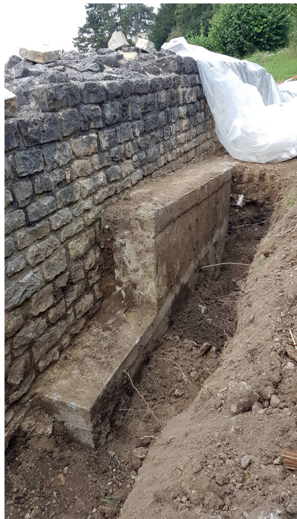
Abb. 28: Augst BL, Taberna (Monumentenrestaurierung 907.2021.01). Eine hangseitige Sondage an der Aussenseite der rückwärtigen Tabernenmauer legte die in den 1960er-Jahren geschaffene Konservierungssituation offen, bei der eine Stahlbetonmauer zur Entlastung vorgeblendet worden war.
