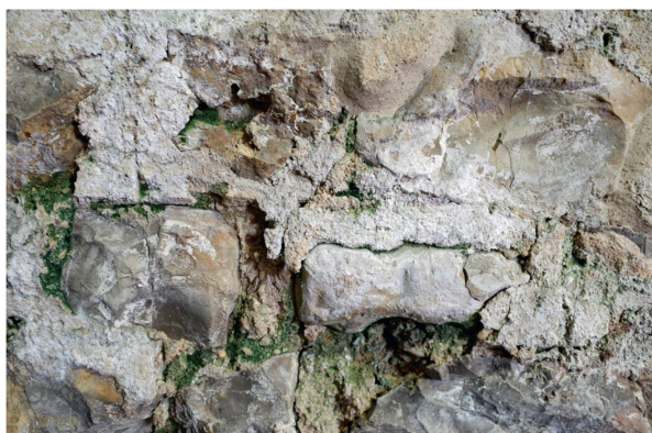
Abb. 25: Augst BL, Taberna (Monumentenrestaurierung 907.2021.01). In der nachfolgenden Abtrocknungsphase kam es zu massiven Salzausblühungen an der Maueroberfläche, sodass eine grossflächige Zerstörung der antiken Originalmörtel zu befürchten war.
