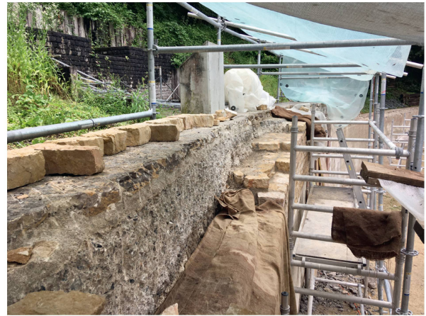
Abb. 7: Augst BL, Amphitheater (Monumentenrestaurierung 905.2021.01). Links im Bild die vorbereiteten Abdecksteine der neuen Überkronung, auf der rechten Seite der Übergang vom neu errichteten Schalenmauerwerk zum Kernmauerwerk.
