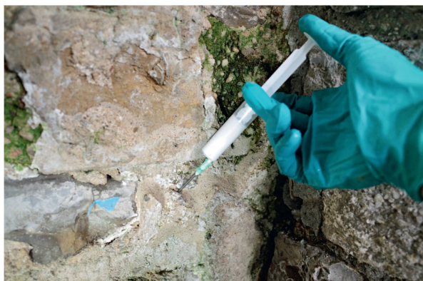
Abb. 26: Augst BL, Taberna (Monumentenrestaurierung 907.2021.01). Als unverzügliche Massnahme wurden zur Stabilisierung des Mörtels Injektionen mit Nanokalk vorgenommen.
