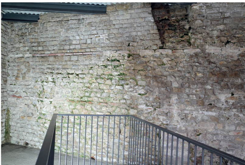
Abb. 23: Augst BL, Taberna (Monumentenrestaurierung 907.2021.01). Taberna an der Giebenacherstrasse. Notfallmässige Konservierungs- und Konsolidierungsarbeiten an der rückwärtigen Tabernenwand. Die hangseitige Tabernenrückwand zeigte nach schweren Regenfällen im August 2021 eine extrem starke Durchfeuchtung.
