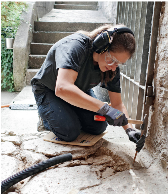
Abb. 17: Augst BL, Curia (Monumentenrestaurierung 906.2021.02). Chiara Marcon beim Konservieren der fragilen Kalksteinschwelle. Der alte, zum Teil noch Zement enthaltende Restauriermörtel muss sorgfältig von Hand mit Hammer und Meissel entfernt werden. Darunter kommen die abgelösten und von Rissen durchzogenen Überreste der antiken Originalschwelle zum Vorschein.
