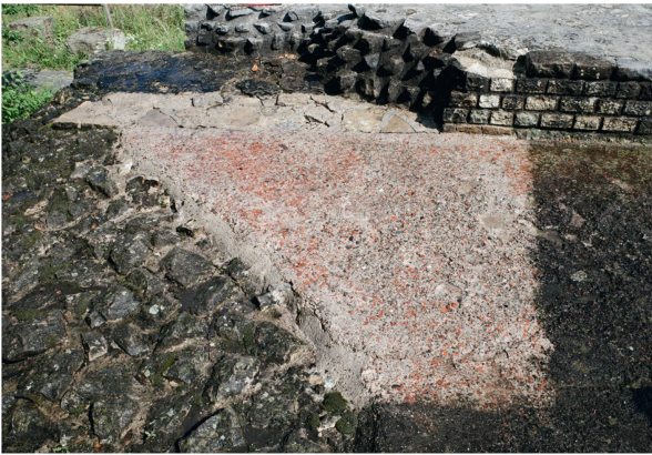
Abb. 33: Kaiseragust AG, Castrum Rauracense (Monumentenrestaurierung 915.2021.01). Im Rahmen der Reinigungstests hat sich gezeigt, dass die originalen Turmböden aus ziegelschrothaltigem Terrazzomörtel noch in erstaunlich gutem Erhaltungszustand sind.
