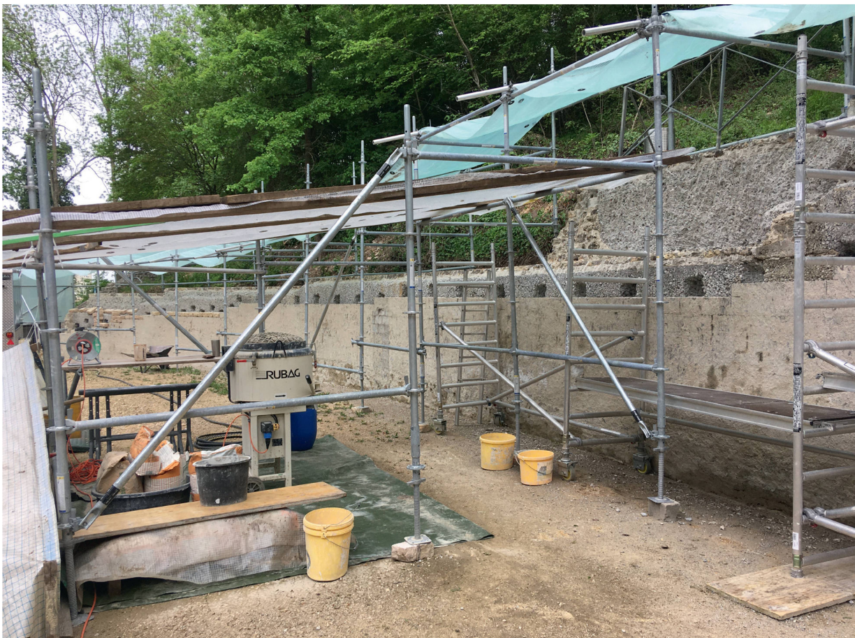
Abb. 5: Augst BL, Amphitheater (Monumentenrestaurierung 905.2021.01). Zum Aufmauern der zu erneuernden Mauerzonen vorbereiteter Mauerzug. Die Löcher im Betonkern dienen zum Einsetzen von einbindenden Handquadern, um eine bessere Verankerung des neuen Schalenmauerwerks zu erlangen.
