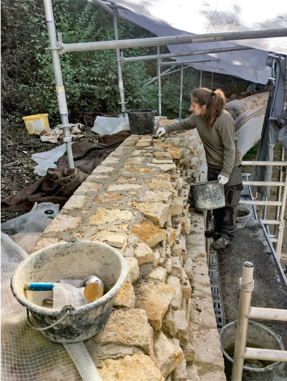
Abb. 9: Augst BL, Amphitheater (Monumentenrestaurierung 905.2021.01). Chiara Marcon beim Fertigstellen der obersten Steinlage der neuen, als Kernabbruch gestalteten Überkronung.
