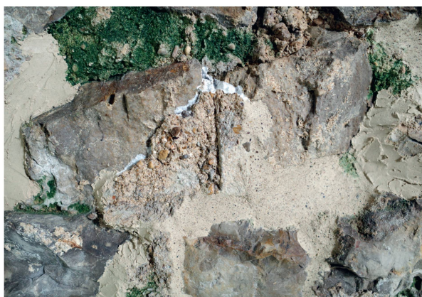
Abb. 27: Augst BL, Taberna (Monumentenrestaurierung 907.2021.01). Sämtliche Fehlstellen wurden mit Kalkmörtel geschlossen. Zum Zurückkleben der abgelösten Fugmörtel fand ebenfalls Nanokalk Verwendung, zusätzlich wurden die fragilen originalen Kanten mit Mörtelanböschungen gesichert.
