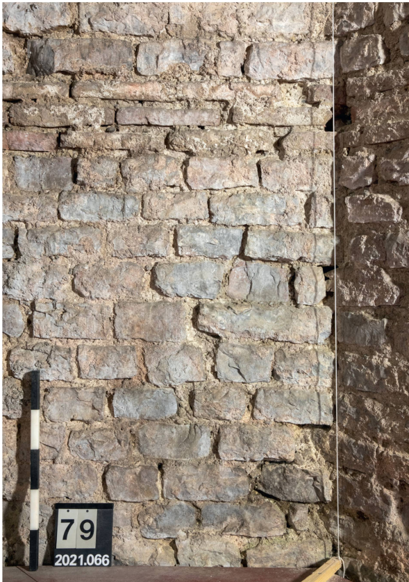
Abb. 18: Augst BL, Curia (Intervention 2021.066). Innenraum, Blick von Norden auf den unteren Mauerbereich von MR 1m und an die Verbindung zur rückwärtigen Curiamauer MR 9. Die leicht abgekippten Steine und die zum Teil hohl gebliebenen, zum Teil vermörtelten Ausbrüche zeigen, dass MR 9 nachträglich in MR 1m eingezahnt worden ist. Bei dem hierfür nötigen Ausbruch wurden verschiedene Handquader des Schalenmauerwerks von MR 1m herausgerissen oder verschoben.
