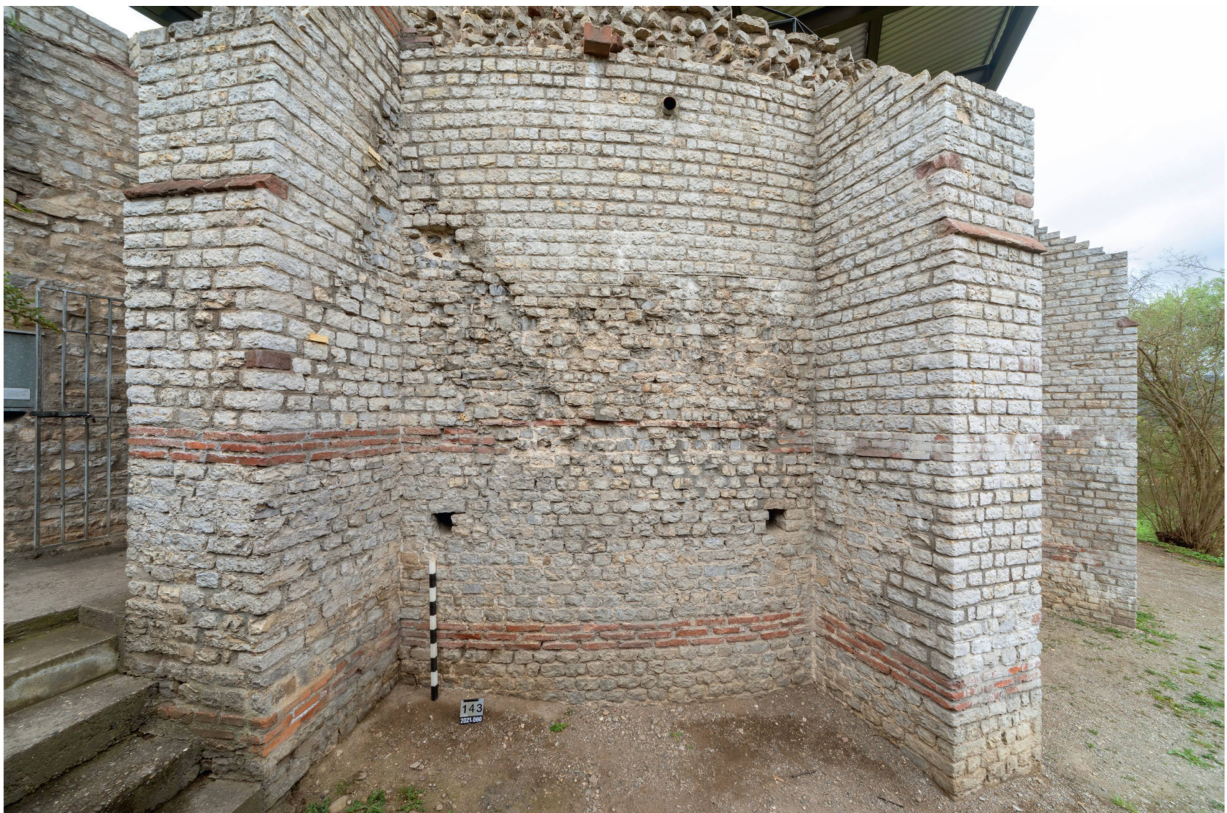
Abb. 13: Augst BL, Curia (Intervention 2021.066). Aussenseite, Blick von Südosten an den Abschnitt MR 1g. Das zwischen den Stützpfeilern MR 8 und MR 7 befindliche zugemauerte Fenster (Fenster 3) (Beilage 2B,8) ist nicht nur dank der Baufugen, sondern auch durch das qualitativ schlechtere Steinmaterial deutlich ablesbar. Vermutlich wurden nach dem Brand die noch brauchbaren, aber durch die Hitze geschwächten Handquader wiederverwendet.
