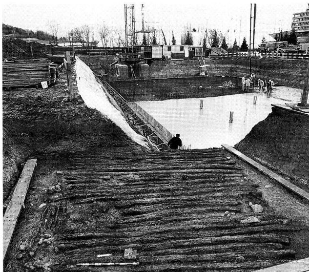
Abb. 21. Otelfingen ZH, Lauet. Der Prügelweg aus Erlen- und Eschenstämmen. Blick nach Osten in Richtung des Strassenverlaufs.
