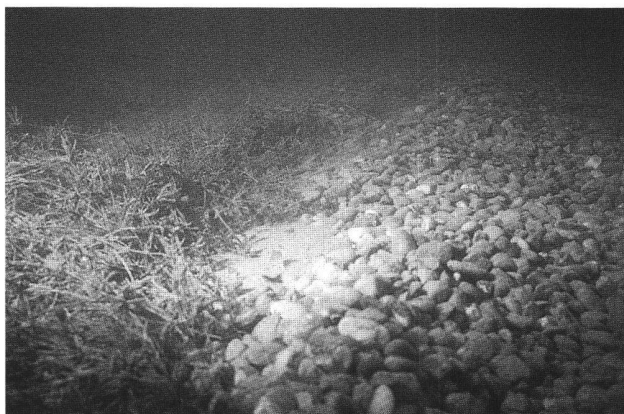
Abb. 27. Ermatingen-Westerfeld. Die Überdeckung am Seegrund nach Abschluss der Arbeit, Dezember 1998. Aufnahme AATG, M. Schnyder.
