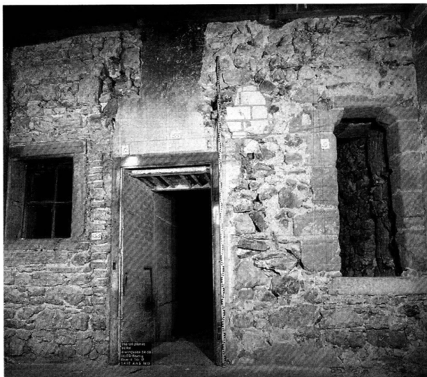
Abb. 33. Bern BE, Brunngasse 56. Blick auf die Nordseite der Stadtmauer mit jüngeren Durchbrüchen und Unterfangungen. Rechts die Kragsturztür des 13. Jh. Photo ADB, D. Kissling.
