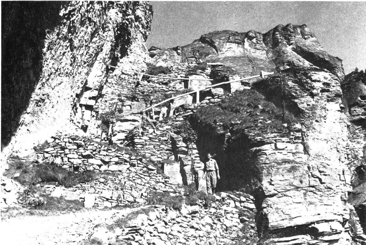
Fig. 19: Gemmi-Südseite: Warms Loch (AERNI 1971: Tafel 4, Ziff. 18). – Gebauter Weg von 1739–43, mit bautechnisch und topographisch ausgeglichener Steigung. Wegoberfläche kiesig, Randpflaster steil eingesetzt. Stützmauern aus Bruchsteinen in wildem Verband und mit vorwiegend horizontal liegenden Längsachsen. An einigen Stellen ist Zement in die Fugen gestrichen. In Figur 20 ist ein steingerecht gezeichneter Ausschnitt aus dem Raum des ersten Holzpfostens vom linken Bildrand her dargestellt.
