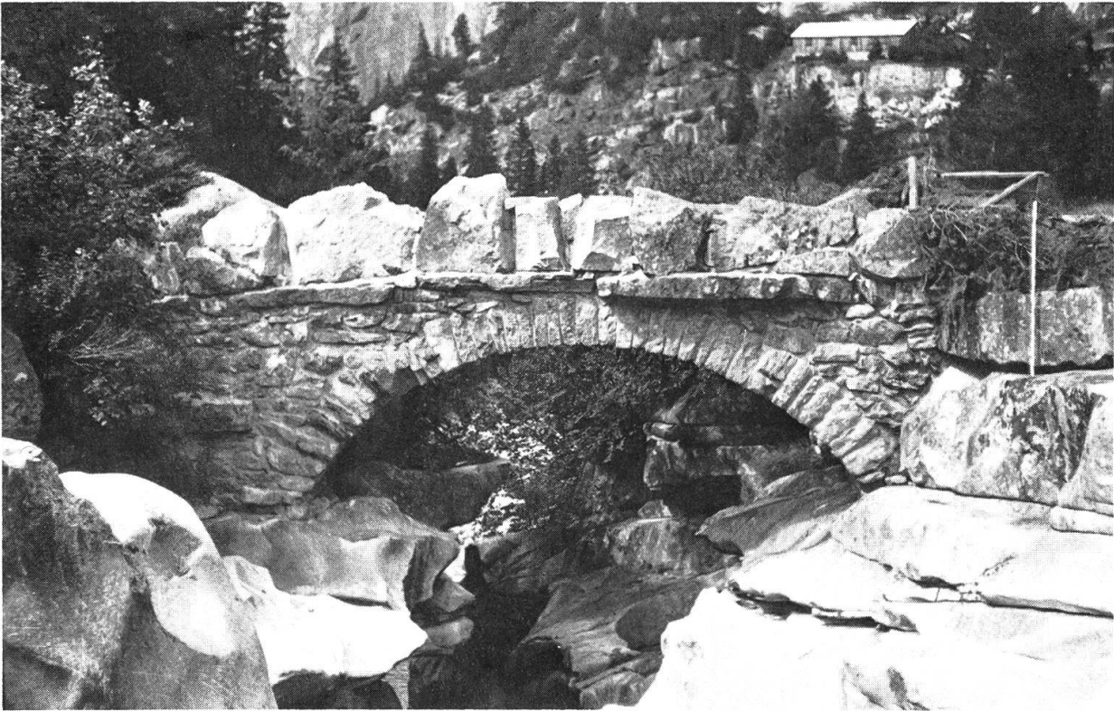
Fig. 13: Grimsel-Nordseite: Kleine Böglisbrücke in Kunzentännlen (AERNI 1971: Tafeln 8 und 9, Ziff. 38, A 46). – Die steinerne Gewölbebrücke hat eine Spannweite von 6,3 m und einen Bogenstich von 2 Metern. In der bloss 2–4 Meter breiten Klamm zeugen wundervolle Kolkerscheinungen von der Erosionsarbeit der Aare, die sich hier etwa 12 Meter in den Granit eingetieft hat (vgl. Fig. 14). Vergleichsstrecke am rechten Bildrand: 2 Meter.
