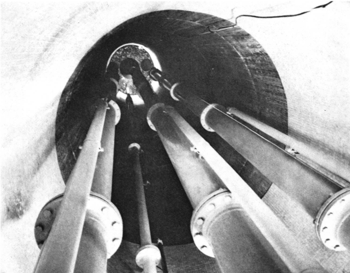
Abb. 3 Blick in eine Grundwasserfassung in Gimmiz
