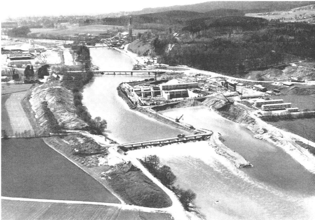
Abb. 25: Das Aarekraftwerk Flumenthal: Flugaufnahme der Baustelle für Maschinenhaus und Wehr. Im Vordergrund das provisorische Absturzbauwerk, im Hintergrund die Cellulosefabrik Attisholz. Bauzustand Anfang Mai 1969, etwa zwei Wochen vor dem Fluten der Baugrube. (Aus: D. Vischer und P. Fischer, 1969)
