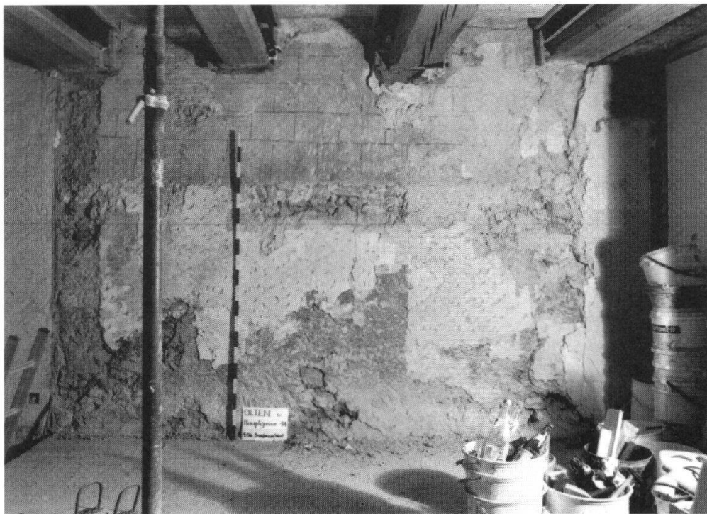
Abb. 4: Brandmauer West, 1. Obergeschoss, Partie Nord. Erkennbar ist in der oberen Wandhälfte die Quadermalerei zur spätgotischen Wandmalerei, darunter (über der horizontalen Messschnur) ein Bodennegativ.
