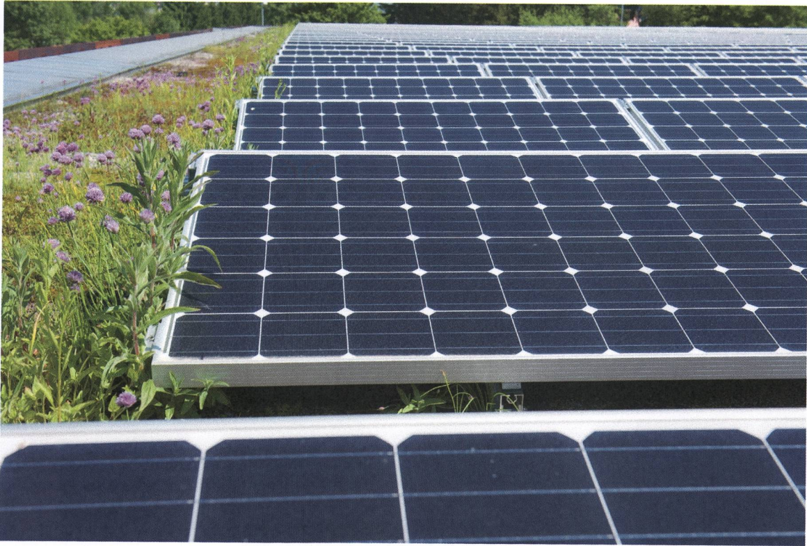
Die Photovoltaikanlage auf dem Dach des Sammlungsentrums in Affoltern am Albis.
