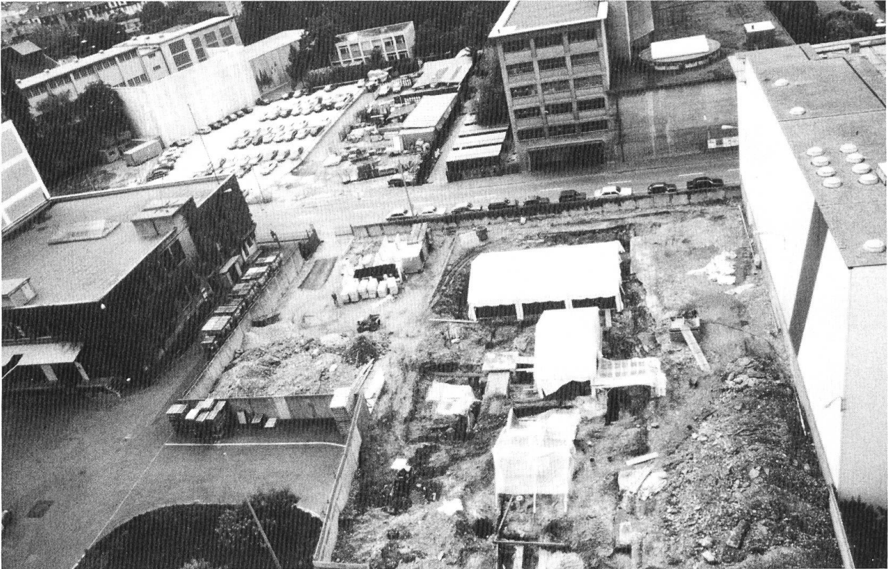
Ausgrabung im Industriegelände. Die Teilflächen, an denen gerade gearbeitet wird, werden mit Zelten gegen die Witterung geschützt.
