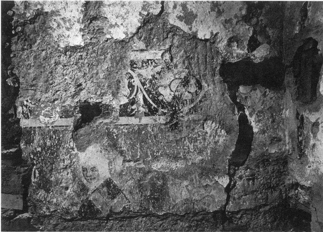
Abb. 1. Dinhard. Reformierte Kirche. Schiff-Südmauer. Überreste eines hochgotischen Gemäldezyklus bei der Südwestecke
