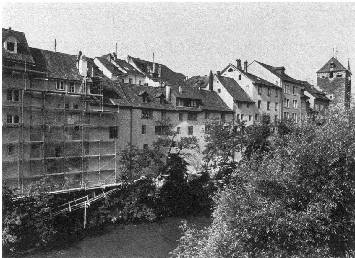
Brugg. Elfteilige Häuserreihe an der Haupt- und Falkengasse, die gesamthaft restauriert wurde
