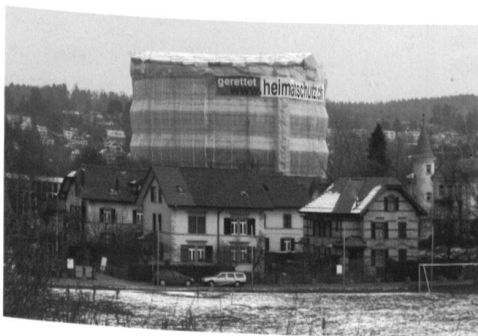
Gerettet dank der Hilfe des Heimatschutzes: Der Gasometer in Schlieren. Sauv  avec l'aide de Patrimoine suisse: le gazom tre de Schlieren. (SHS)
