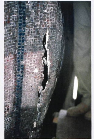
Aufgeplatzte, abstehende Mosaikoberfläche mit grosser Hohlstelle
