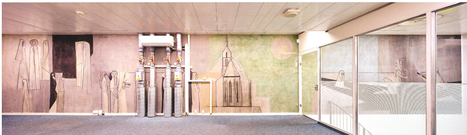
Zwei Ausschnitte zeigen den Zustand des Gemäldes von Judith Müller, Elftausend Jungfrauen (1959/60, Tempera auf Putz, 280 × 1680 cm) im Jahr 2020. Heute befindet es sich im Dienstbereich der Schalterhalle der Hauptpost Basel und ist dem Publikum nicht zugänglich. Fotos Dirk Weiss
