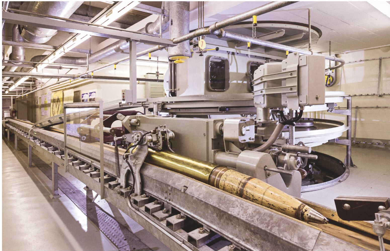
Moderner Festungsbau, der wie eine Industrieanlage wirkt: das bis 2017 genutzte Fort Dailly im Wallis, das in einer unterirdischen Kaserne Platz für 650 Mann bot. Blick in den Laborier-raum zum Vorbereiten eines Geschosses für die 15-cm-Turmkanone. Foto Michael Peuckert
