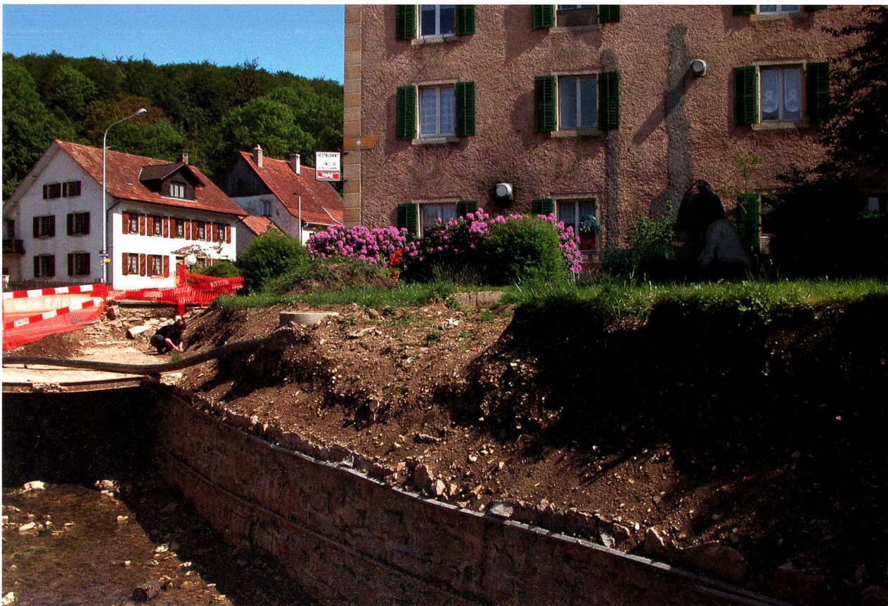
Fig. 2: Vue du site de l'ancienne faïencerie de Cornol entre le moment de l'éboulement accidentel et les fouilles, mai 2003. (Photo: U. Babey, Cornol).
