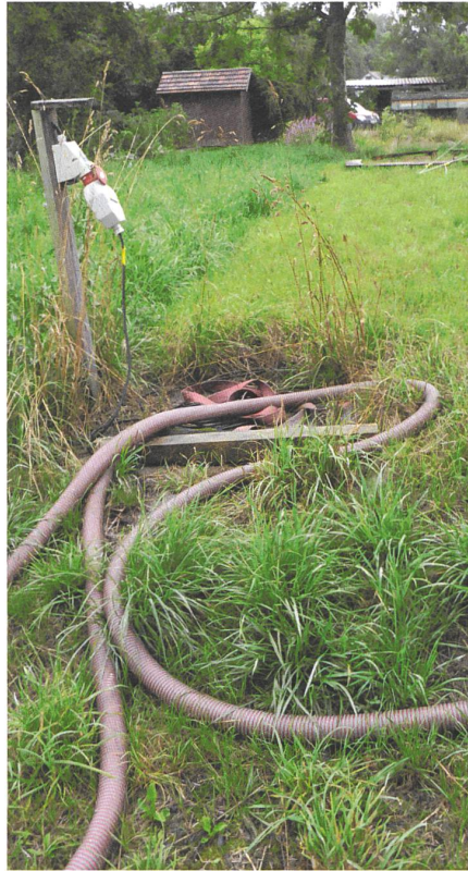
Ein Starkstromanschluss in Zisternennähe erleichtert die Wasserentnahme beträchtlich, weil so die Tiefbrunnenpumpe im Sommer in der Zisterne bleiben kann und nur ein Schalter bedient werden muss.
