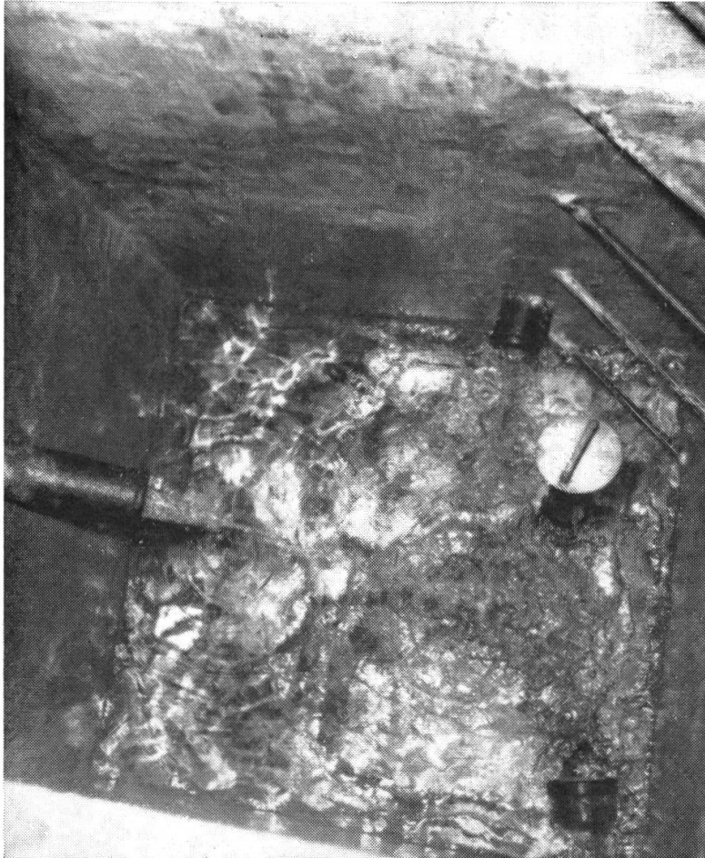
Blick in einen der zwölf Sammelschächte Man erkennt die Einläufe von zwei Quellen und unten rechts die Ablauföffnung nach der Sammelleitung
