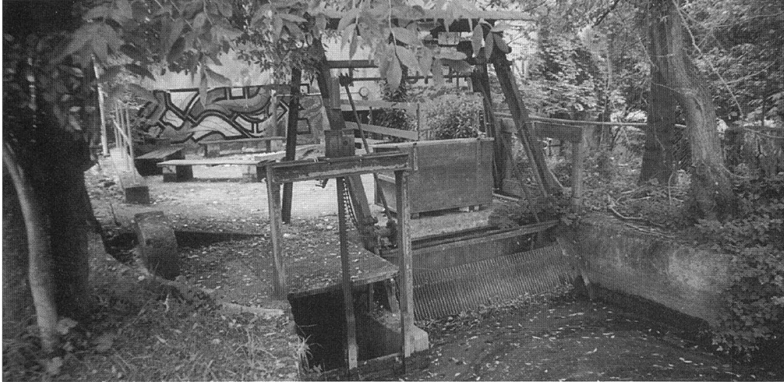
Rechenanlage beim Tommasini in Lenzburg
