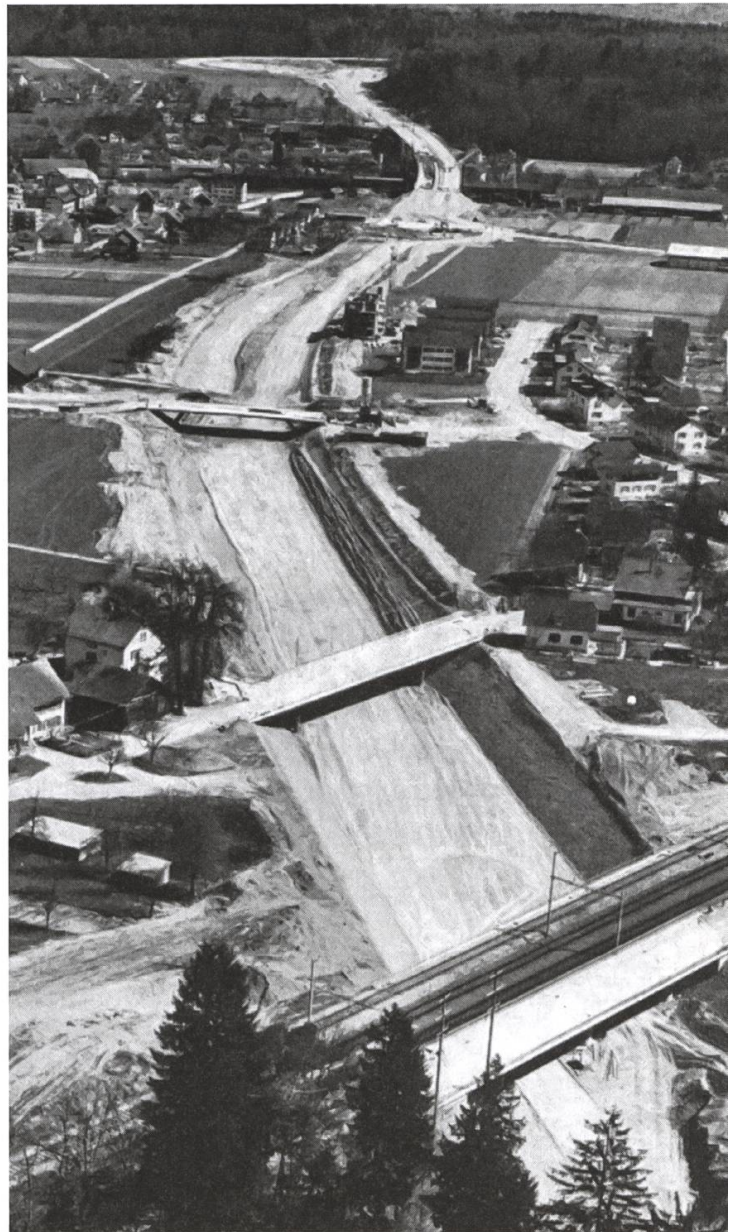
Nationalstrassenbau im Gebiet von Niederlenz (links) – Lenzburg (rechts). Im Bild oben die 360 m lange Brücke über das Aabachtal und das Anschlussbauwerk Lenzburg (vorläufiges Ende der Autobahn Richtung Zürich).
