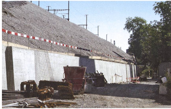
Stützmauer mit frisch geschütteter Dammverbreiterung Foto: D. Salzmann
