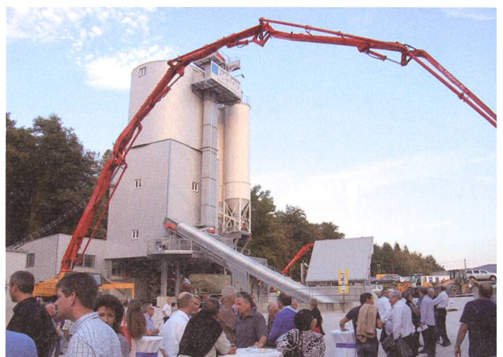
Die neue Betonzentrale sichert den Kiesverkauf. Foto: HH.
