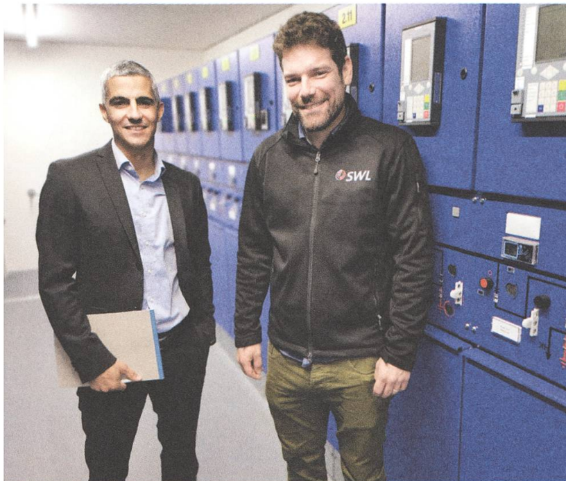
Blick in die neue Trafostation Lenzhard mit den Verantwortlichen der SWL Energie AG, Gian von Planta (Leiter Anlagen und Netze) und Sandro Marquardt (Leiter Elektrizität) FT
