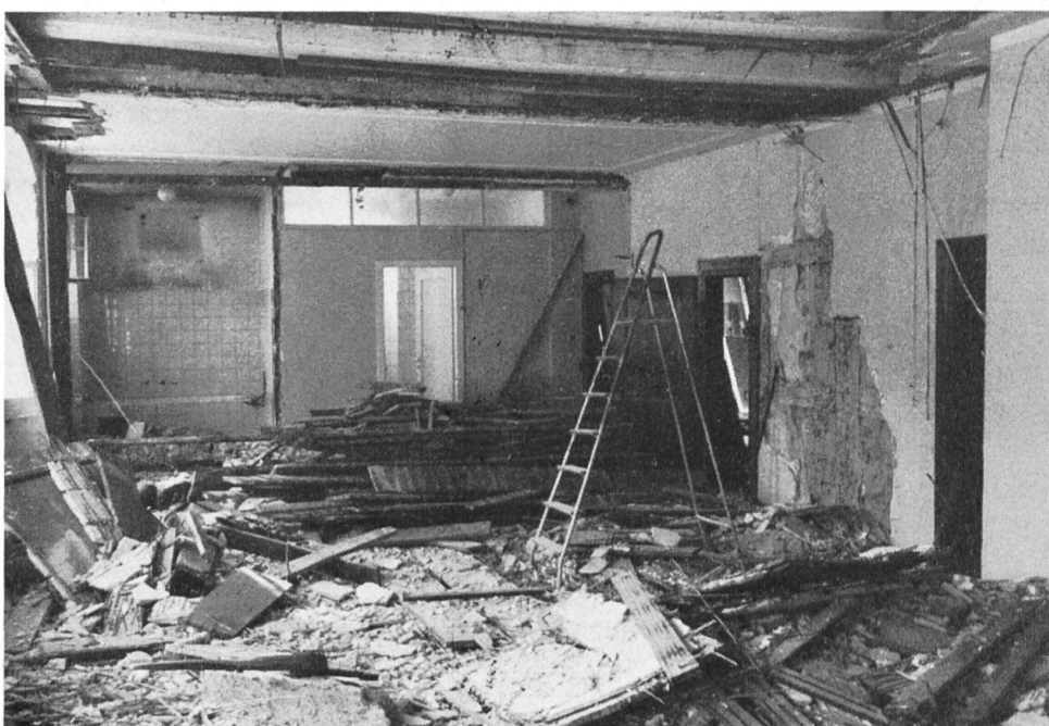
Konventstock, Süd-Ost-Seite. Die mit Brettern eingefügten Zwischenwände wurden herausgenommen und durch eine neue Riegelkonstruktion ersetzt. Hier war ursprünglich die alte Bibliothek.
