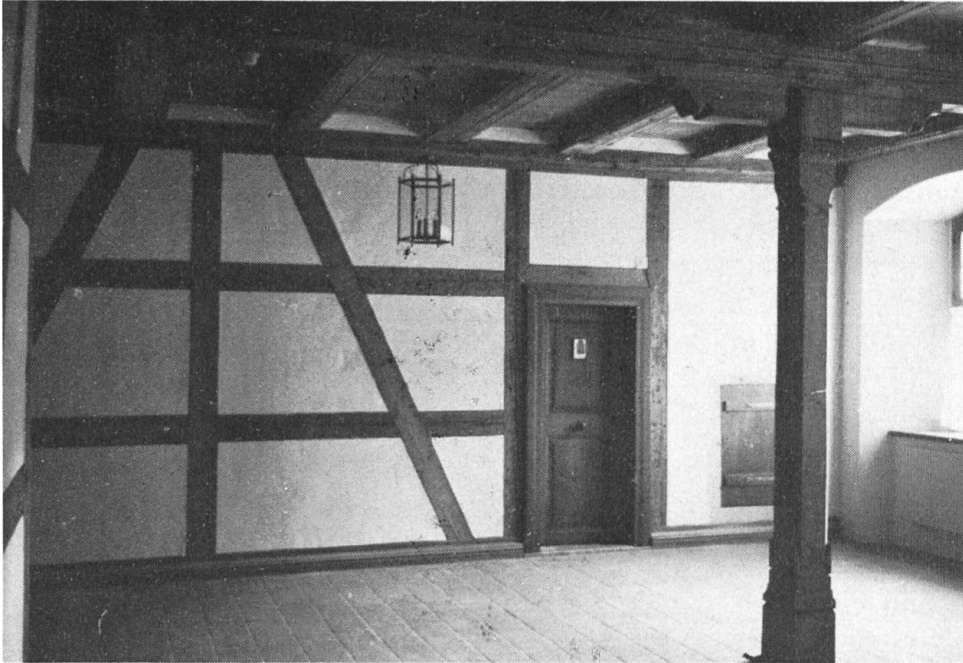
Konventstock, 1. Obergeschoss. Restaurierter Vorplatz bei der Wendeltreppe. Die Riegelkonstruktion ist wieder intakt. So sieht auch die Struktur des ganzen restaurierten Gebäudes aus.
