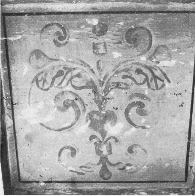
Kapitelsaal. Bemalte Holztafel mit Gipsspritzern und Fehlstellen in der Malerei.
