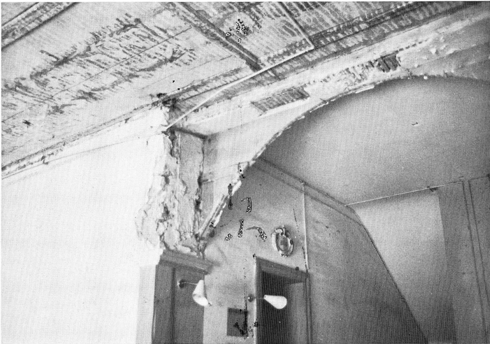
Konventstock, Erdgeschoss. So zeigte sich die mit Ranken bemalte Täferdecke, nachdem die Gipsdecke entfernt war.
