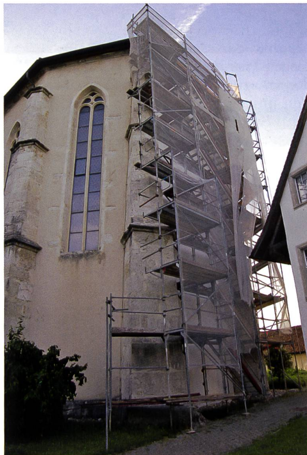
Gerüst am gotischen Chorhaupt der Klosterkirche: Die Sanierungsarbeiten an der Fassade sind noch in vollem Gang.
