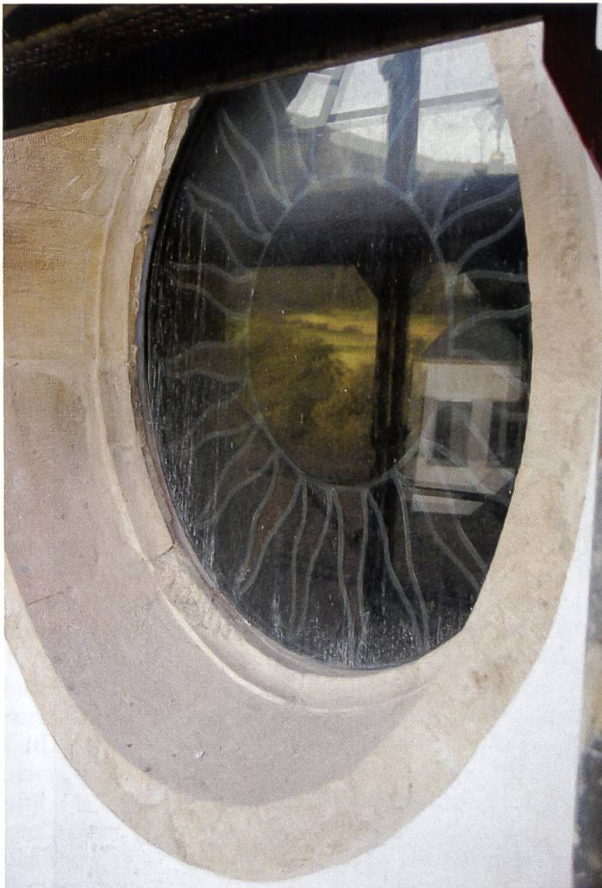
Blick von aussen auf das Rosettenfenster über dem Hochaltar: Im trüben Glas spiegelt sich das Gerüst und das Glockentürmchen auf dem Gästehaus.
