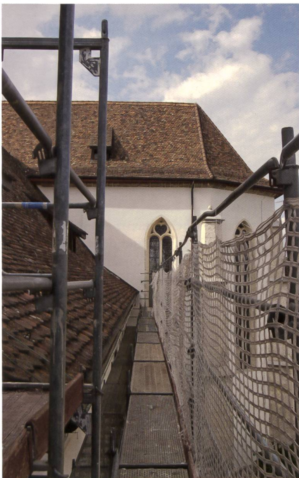
Gerüst an der Ostfassade des Konventbaus (Juni 2014). Die Kosten für die Renovation wurde vom Verein «Freunde des Klosters Mariastein» übernommen.
