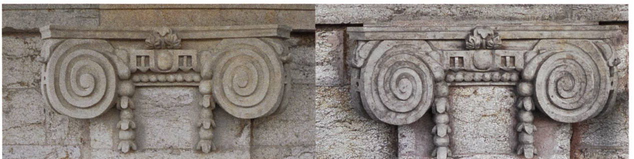
Links: rotes Sandsteinkapitell, gefasst in Kalksteinfarbton. Rechts: Kalksteinimitation mit Pinsel- und Schwammtechnik.
