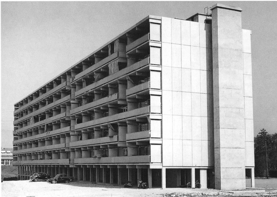
François Maurice, Jean-Pierre Dom et Jean Duret, immeuble locatif SW 3 (1959-1960) à Genève, vue du chantier (le montage des pièces préfabriquées se fait de façon linéaire par la grue) et vue des cadres étayés et des dalles préfabriquées. Vue de la façade sud-ouest.
