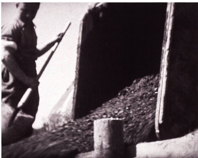
Abb. 31 Die Armee hat den Bau des Werks Grynau begonnen, zivile Firmen führten die Arbeiten zu Ende. Im Bild ein Soldat beim Betonieren von Ständen im Holeneich bei Tuggen. 1
