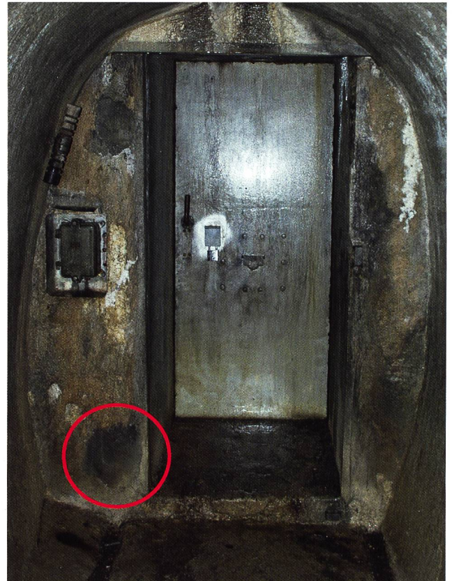
Abb. 49 Türe des Notausgangs geöffnet, rot eingekreist der zubetonierte HG-Auswurf.
