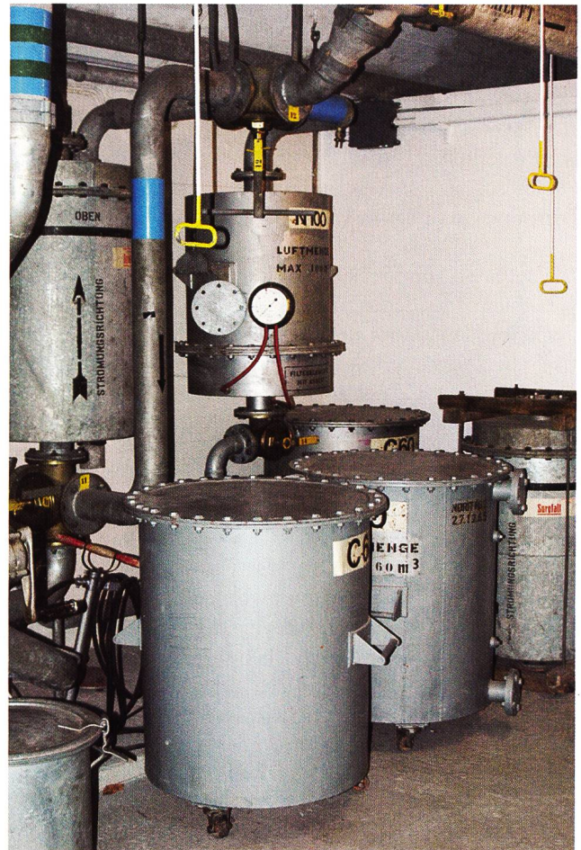
Abb. 62 Die Luftfilteranlage für das gesamte Werk ist bei der Kaverne. Vorne auf Rollen die eigentlichen Filter.
