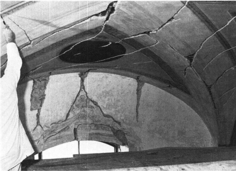
Wollerau, Pfarrkirche: Die Aufnahme zeigt den bedenklichen Zustand der Kirchendecke. Jeder Riß muß möglichst ohne Substanzverlust geöffnet und neu geschlossen werden, bevor die Dekorationsmalerei ergänzt werden kann.
