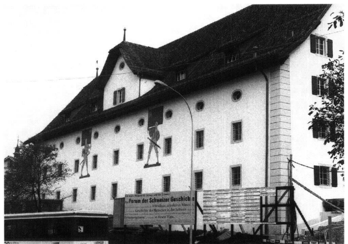
Abb. 1: Schwyz, ehemaliges Zeughaus. Die Fassaden wurden im wesentlichen anhand der überlieferten Substanz saniert. Wieder hergestellt wurden lediglich die Oculi unter dem Dachgesims.
