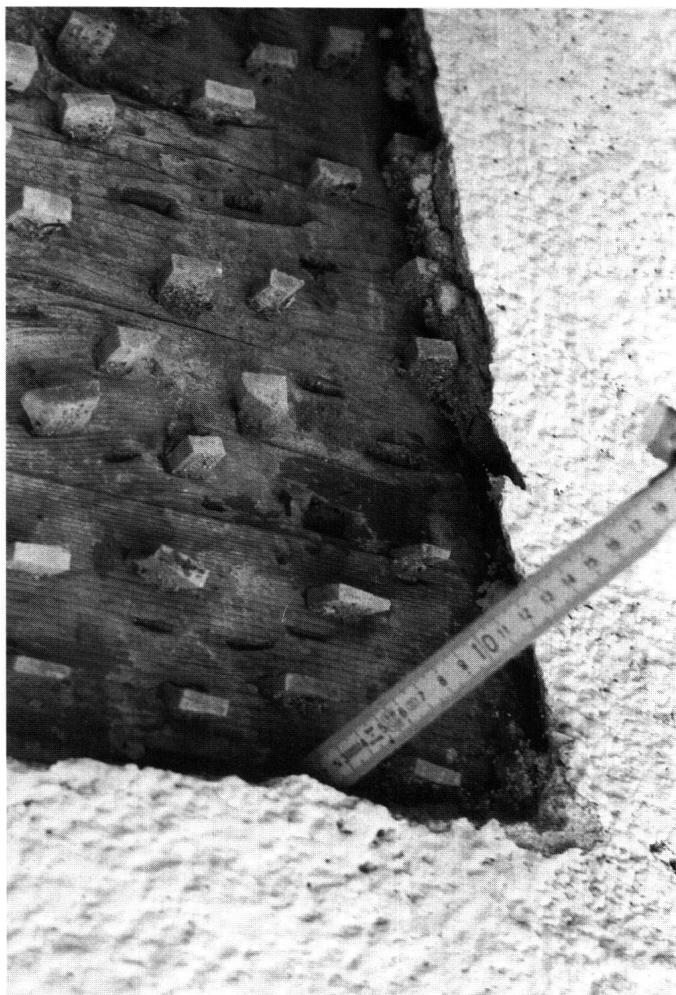
Abb. 4: Schwyz, Haus Appert. Detail der Fassade. Mittels Holznägel wurde der Putz auf den Holzbalken stabilisiert.
