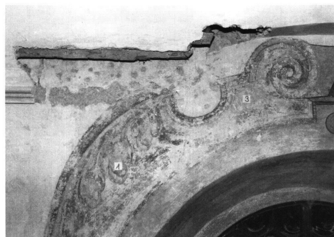
Abb. 13: Einsiedeln, Friedhofkapelle. Die von den Übermalungen befreiten Dekorationsmalereien bei den Fenstern im Kirchenschiff vor den Farbreouchen. Am oberen Bildrand ist deutlich zu sehen, dass der zur Malschicht gehörende Verputz hinter der um 1800 eingezogenen Gipsdecke weitergeht.
