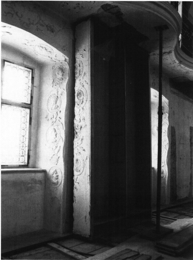
Abb. 15: Einsiedeln, Kloster, Bibliothek. Ein an den originalen Standort zurückversetztes Büchergestell. Gut zu erkennen sind die Beschädigungen an der Seitenwand des Gestells sowie an der Untersicht der Galerie.
