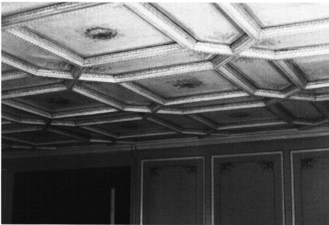
Abb. 1: Schwyz, Ibach, Hof. Decke und Wandtäfer im Salon. Die Decke stammt aus dem 17. Jahrhundert, die Wandtäfer sind eine Ergänzung aus dem 19. Jahrhundert. Gleichzeitig wurde der Raum durch die farbige Behandlung der Wand- und Deckentäfer aufgewertet.
